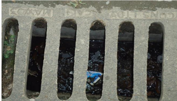
Alcantarilla con residuos en descomposición. Barrio Popular (2015). Sebastián Vargas. (CC BY-SA)
