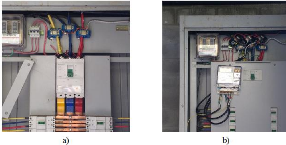
Figura 31. Tablero de distribución principal a) Sin conexión del medidor b) Conexión del A1800 ALPHA METER y los transformadores de corriente.
