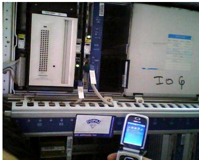
Figura No 18: IOG (Grupo de Entrada Salida I/O) Etiquetado. [Fuente Propia].
