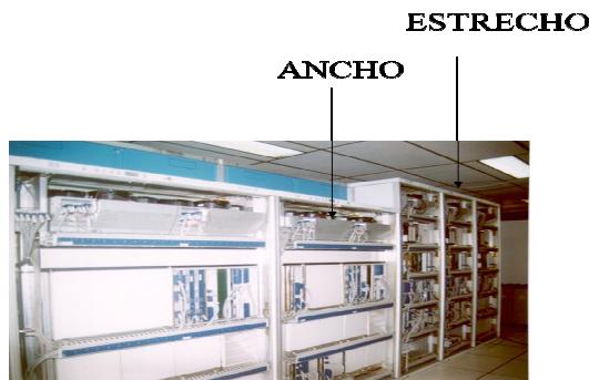
Figura No 38 Tipos de Armarios . [Fuente Propia].
