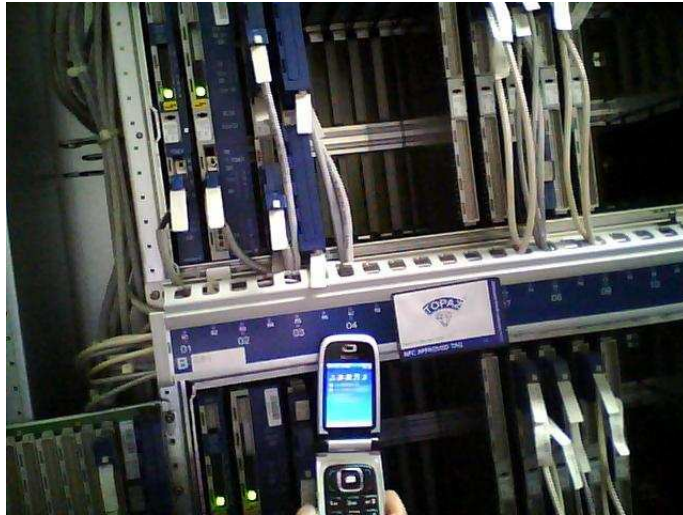
Figura No 19: Relojes/ Módulos de Reloj (CLM=Clock Module)Etiquetados. [Fuente Propia].
