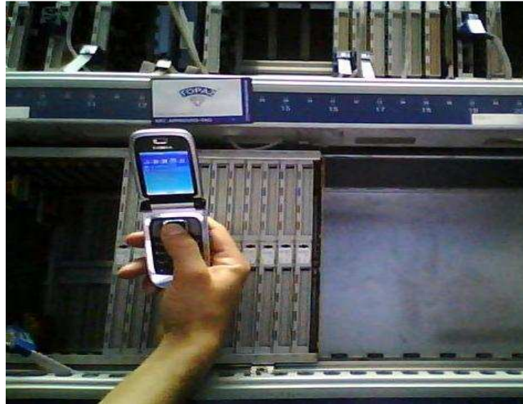
Figura No 21 Conmutador Digital. Etiquetado. [Fuente Propia].
