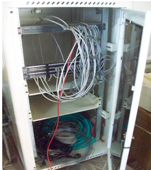
Imagen 0-7: Centro de Cableado 2
