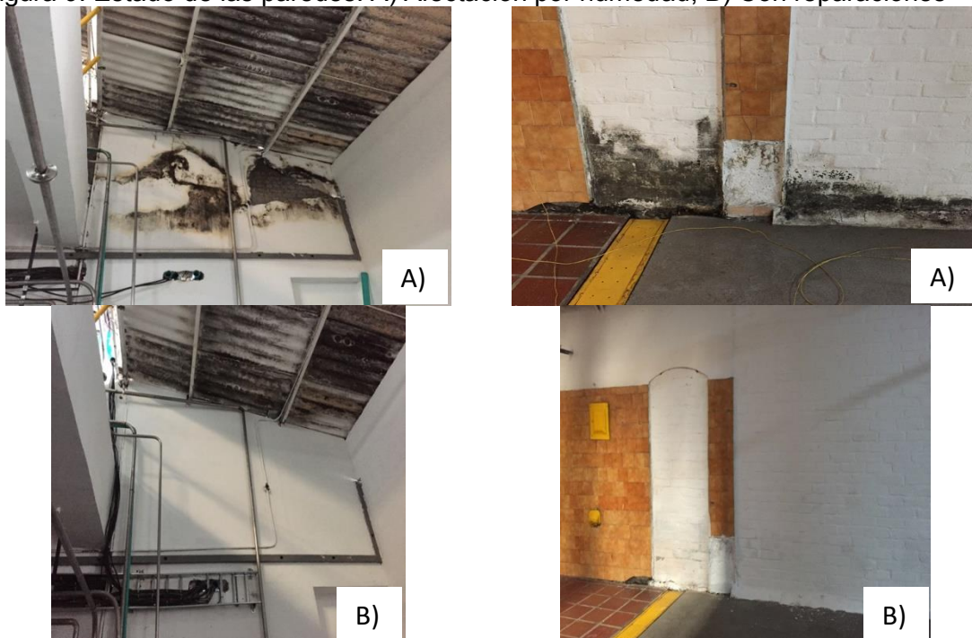
Figura 9. Estado de las paredes. A) Afectación por humedad; B) Con reparaciones
