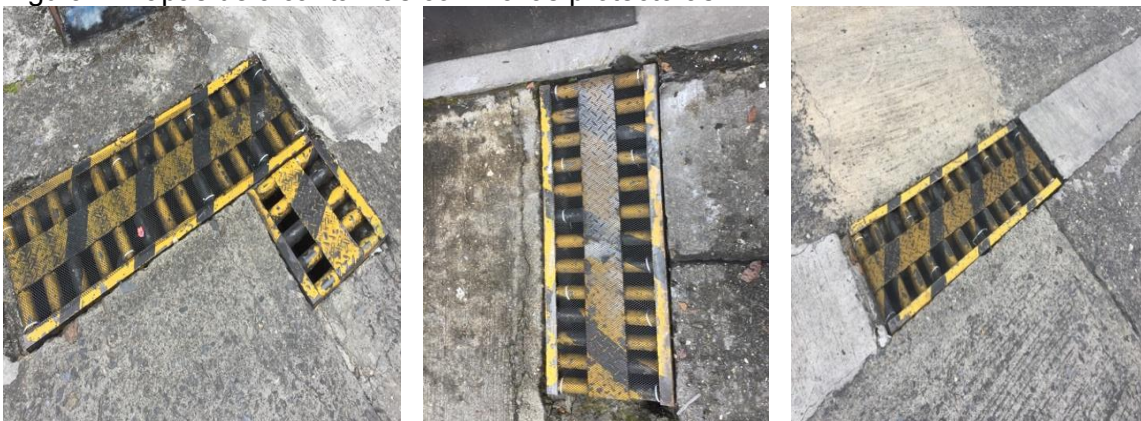
Figura 7. Tapas de alcantarillas con mallas protectoras
