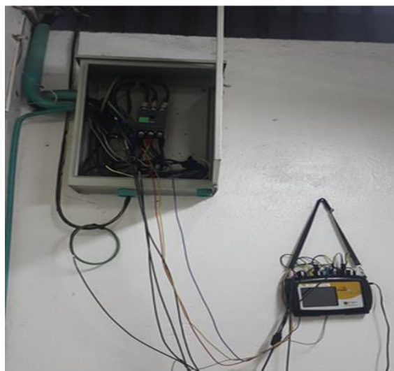
Figura 82. Conexión analizador de red Dranetz. Fuente: propia, agosto de 2016.
