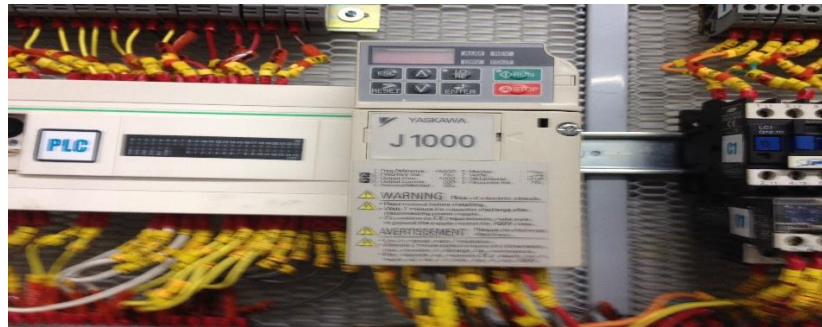
Figura 6.12: VFD que controla la velocidad de giro del motor
