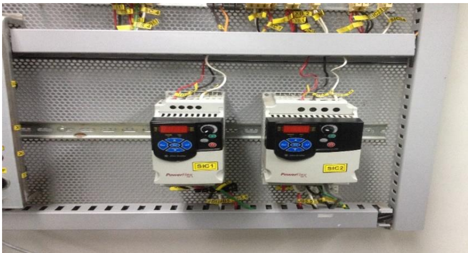
Figura 4.35: VFD que controla la velocidad de giro del motor LabVolt
