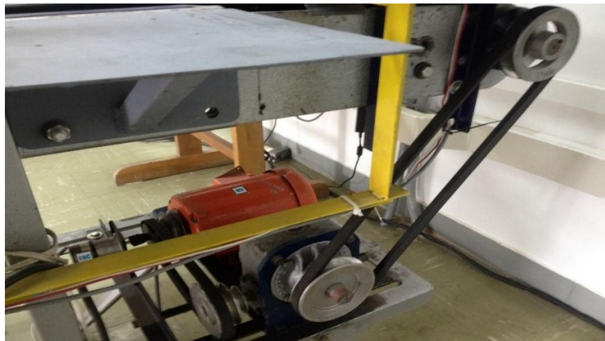
Figura 4.7: Sistema de transmisión por correa del EMDS de la planta clasificadora.
