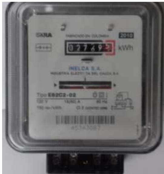
Figura 1: Medidor de energía eléctrica ISKRA E8C2C2 (imagen realizada por el autor)
