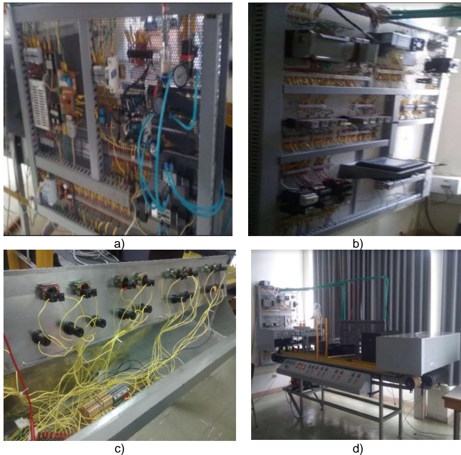
Figura. 34. Estado inicial de la planta clasificadora. a) Panel en campo. b) Panel frontal c) Tablero de control d) Planta clasificadora.
