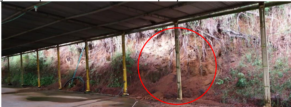
Figura 14. Reptación de talud en el área de compostaje
