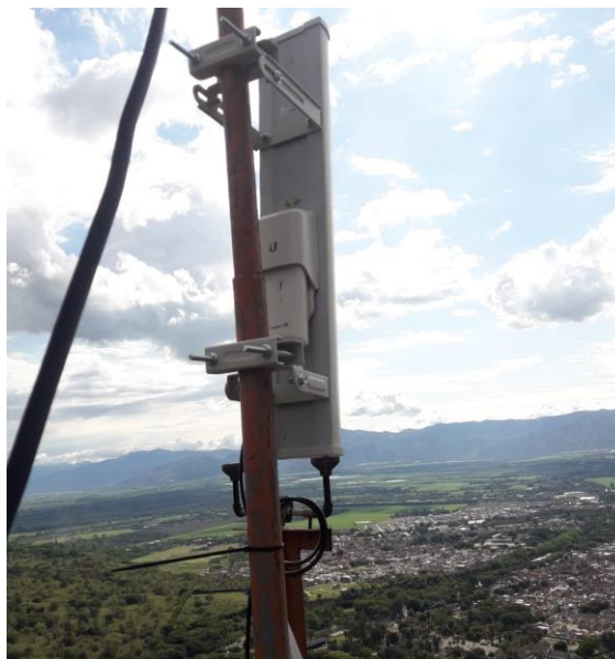
Figura 41. Línea de vista del nodo El Batallón hacia las sedes educativas (sectorial de 90°)
