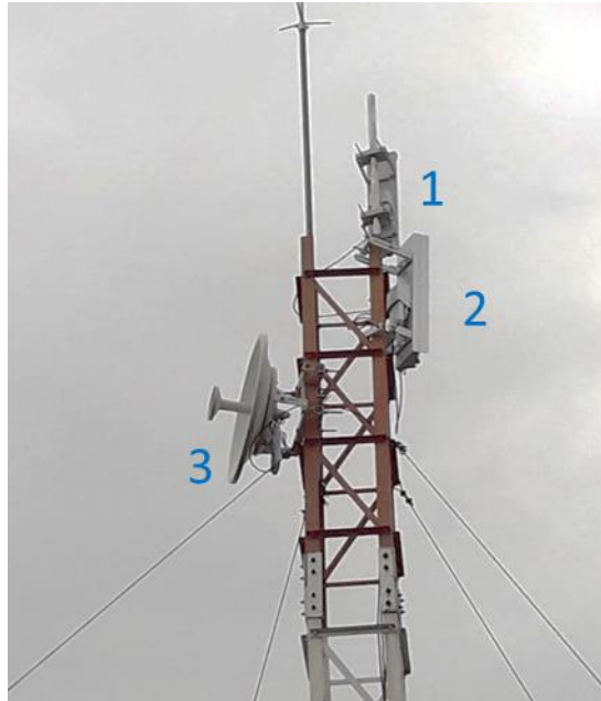
Figura 40. Instalación dispositivo nodo El Batallón
