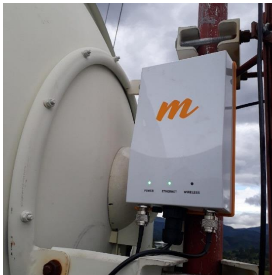
Figura 38. Antena instalada en el nodo Vijos.
