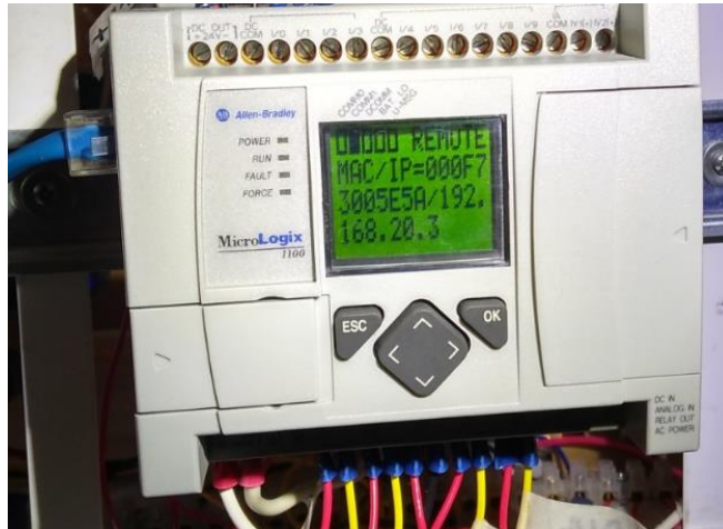
Figura 35: PLC configurado con dirección IP. Fuente propia
