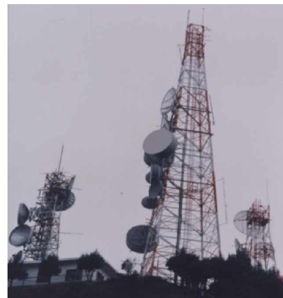
Torre Colombia Telecomunicaciones Cerro Munchique
