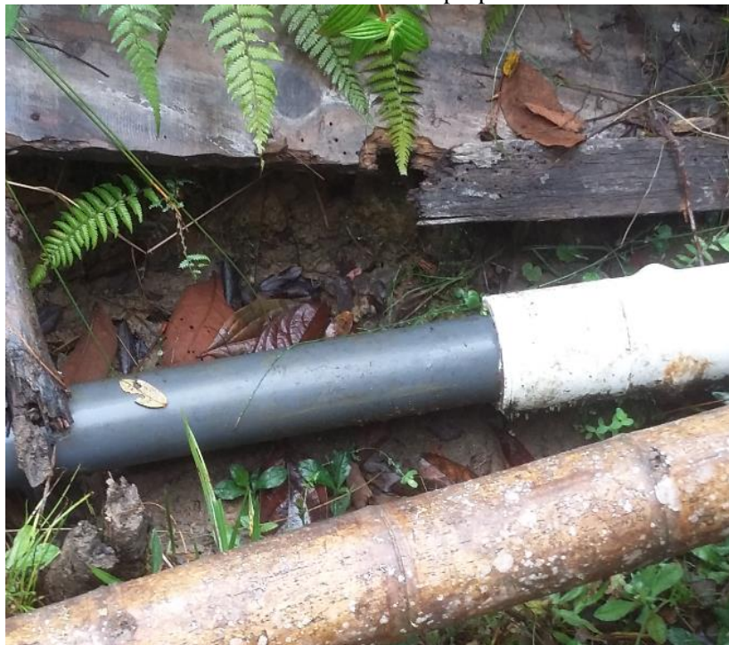
Figura 20. Variación en los diámetros de tubería en la línea de conducción del acueducto
