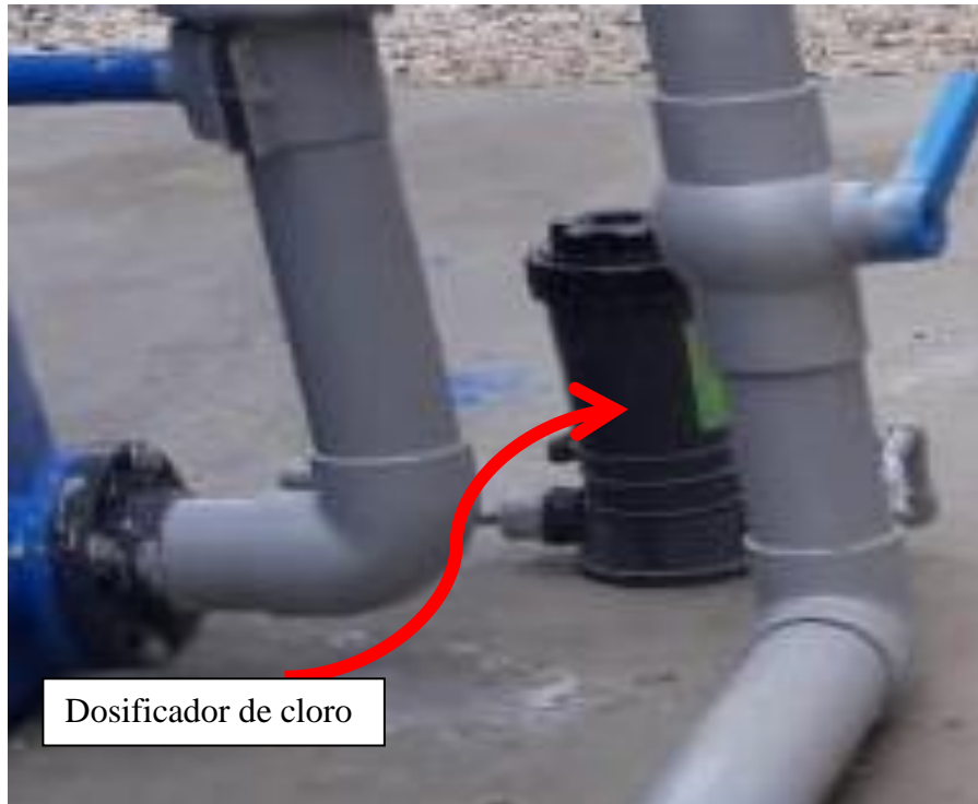
Figura 24. Dosificación de Cloro
