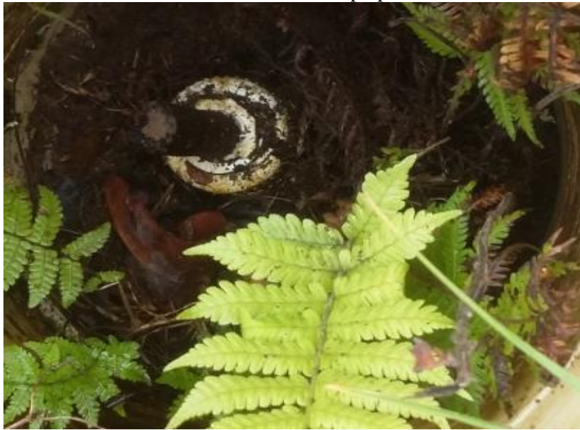
Figura 19. Válvulas ventosas antes del reemplazo
