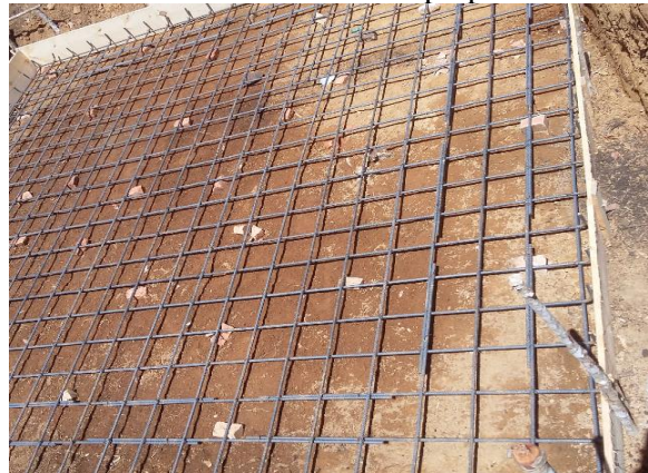
Figura 32. Colocación de acero formaleta para las losas de soporte de la PTAR SAN CRISTOBAL
