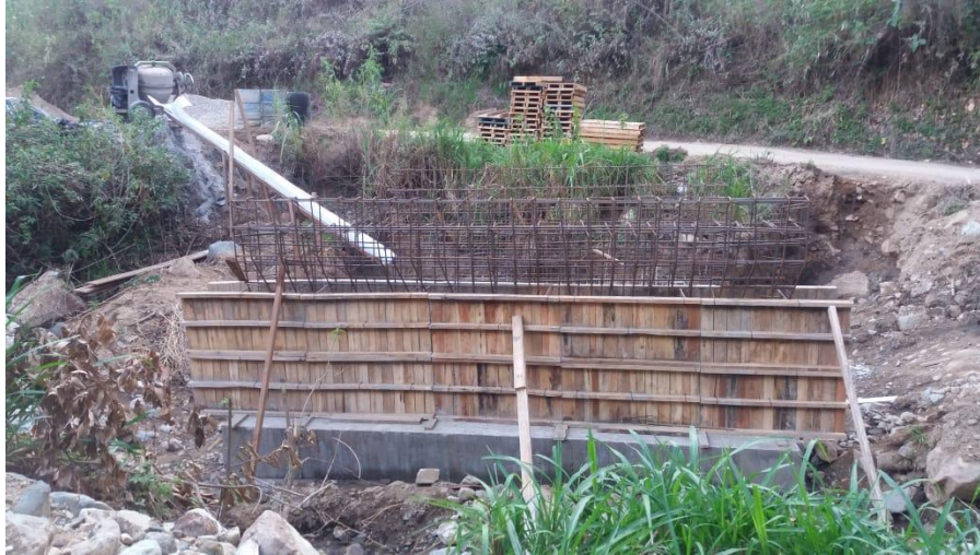
Imagen 39. Figurado de acero faltante de estribo - Pontón Gualpí.
