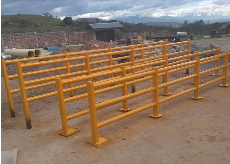
Imagen 31. Baranda de seguridad - Pontón La Mina.
