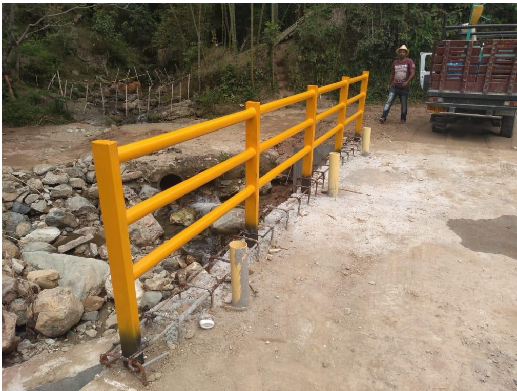
Imagen 52. Barandas de seguridad Instaladas - Pontón Gualpí
