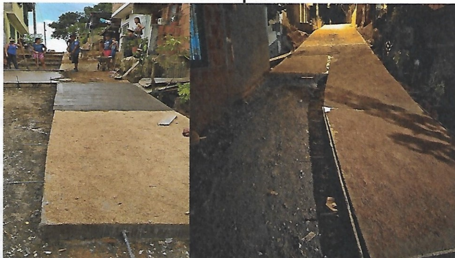
Figura 8. Curado del concreto de las losas Calle 6B entre carreras 13C Sur y Principal
