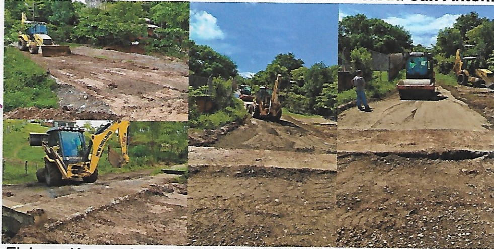
Figura 40. Cajeo, conformación y compactación de la estructura del pavimento en la vía del sector Potrerito en la vereda San Antonio
