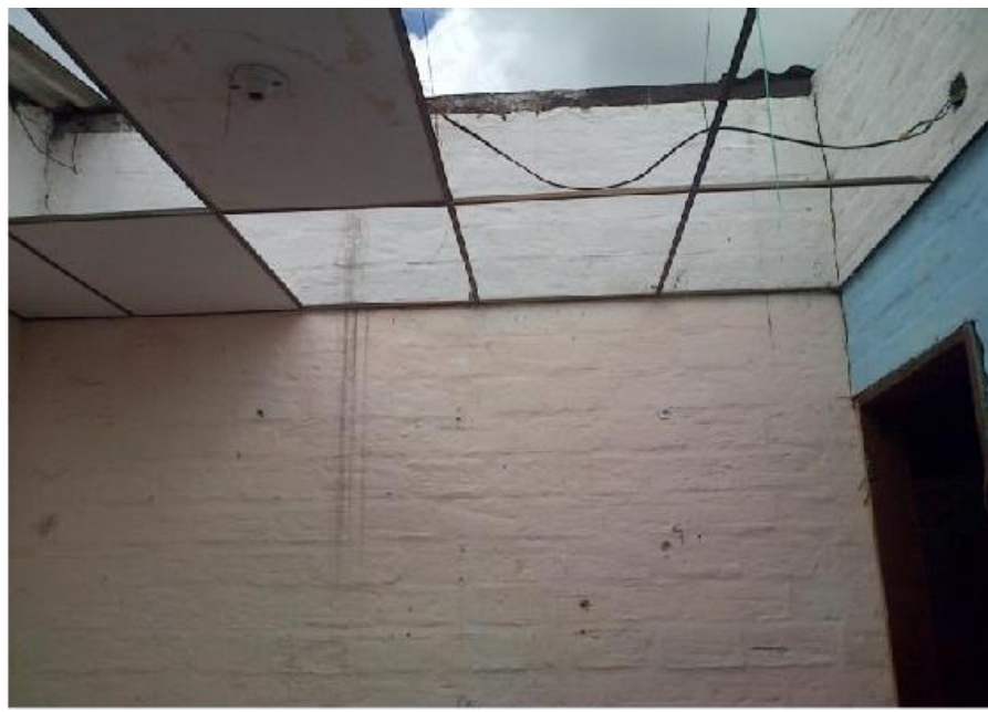
Figura 4. Parte de la estructura del techo del salón de clases destruido por aguacero. Fuente construcción propia
