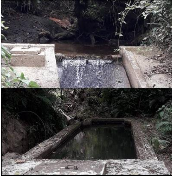
Bocatoma y tanque de almacenamiento, Acueducto Interveredal. Fotografía: David Fernando Quiguanás y María Camila Prado, Vereda Santa Elena, Subcuenca Río Molino, Agosto de 2018
