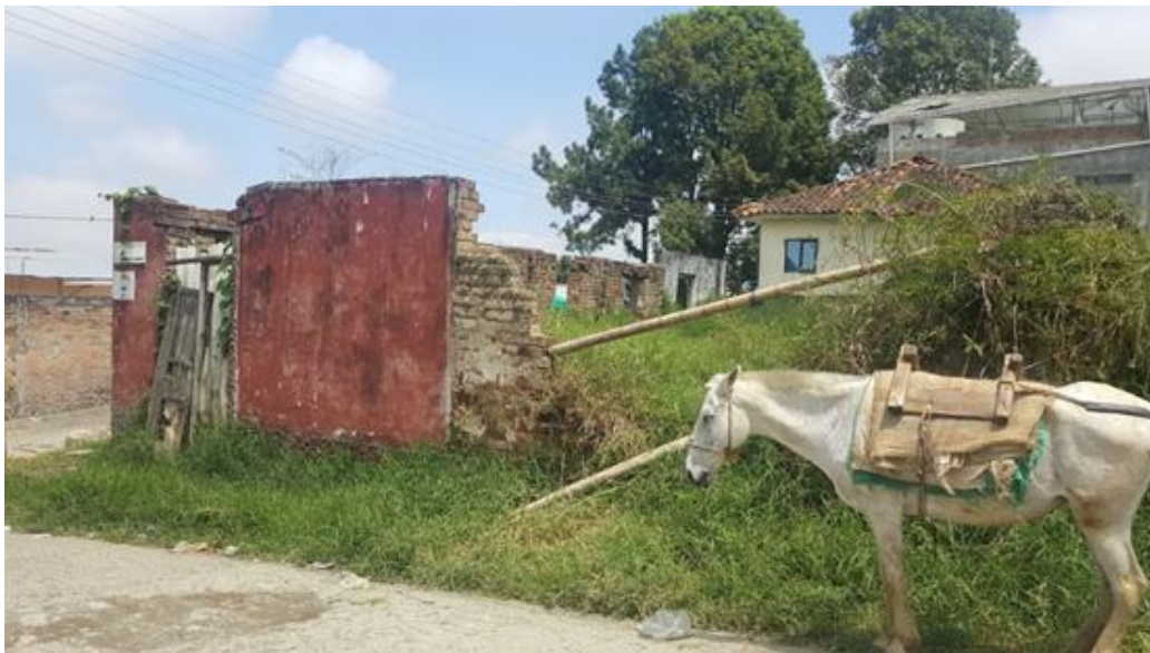
Fotografía No 4: Casa al lado de la policía, destruida en Caldon-Cauca, por las diversas tomas guerrilleras al pueblo.
