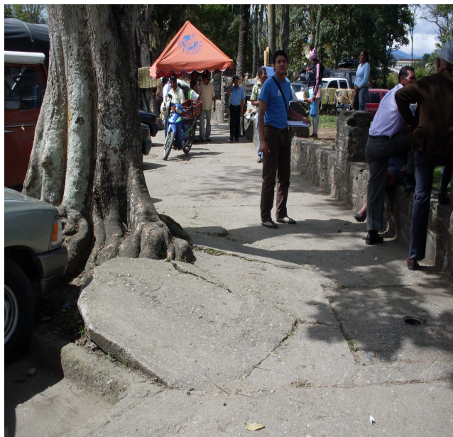
Figura 11. Parque Mosquera levantamiento de placas (limitación 6). La especie Spathodea campanulata genero daños en las vía peatonal del parque.
