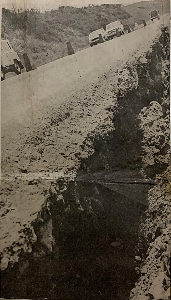
A la entrada de Popayán, la carretera Panamericana sufrió agrietamientos que impiden el normal tránsito de vehículos. El mismo que semides- truyó la capital caucana, ha dejado un estruendo saldo de víctimas y enormes pérdidas materiales. (Foto James Arias, EL PUEBLO).
