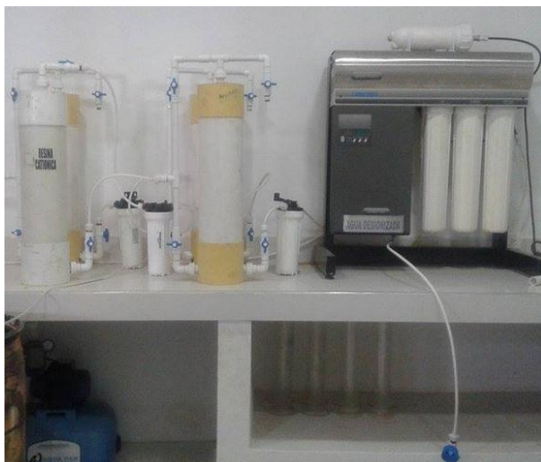
Fig. 10 Sistema de obtención de agua desionizada en la empresa Construcsuelos Suministros Ltda.
