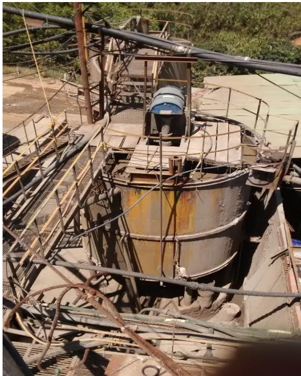
Figura 7. Zona de cianuración. Reactor.
