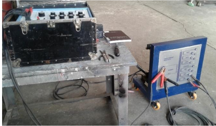
Figura 66. Ensayo relación de transformación
