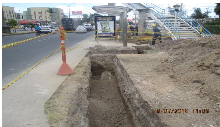
Figura 14. Recebo Arenoso para lecho de tubería ( carrera 9 con calle 25N Colegio Las Salesianas)
