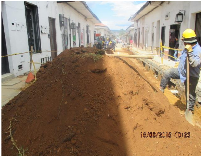
Figura 6. Rechazo de material de préstamo en el tramo 3 (carrera 9 entre calles 5 y 6)
