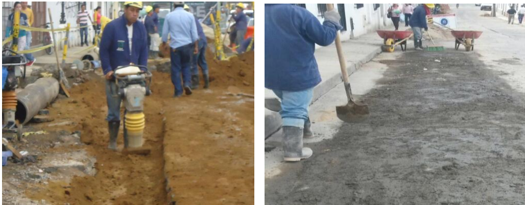
Figura 15. Relleno de material común y rigo de base mejorada (carrera 9 entre calle 2 y 3 Centro)
