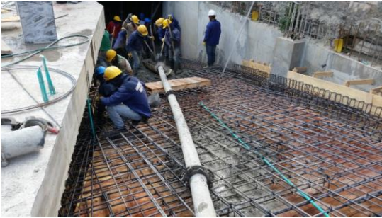
Figura No 68 TRANSPORTE MEDIANTE. TUBERIA DE ACERO
