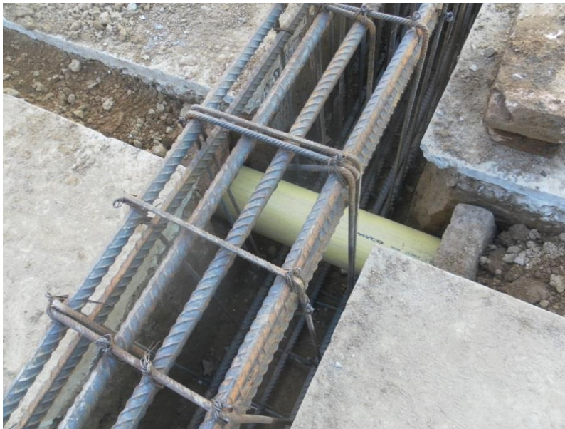
Figura 34.0 Tubería de Pvc atravesando viga de cimentación.
