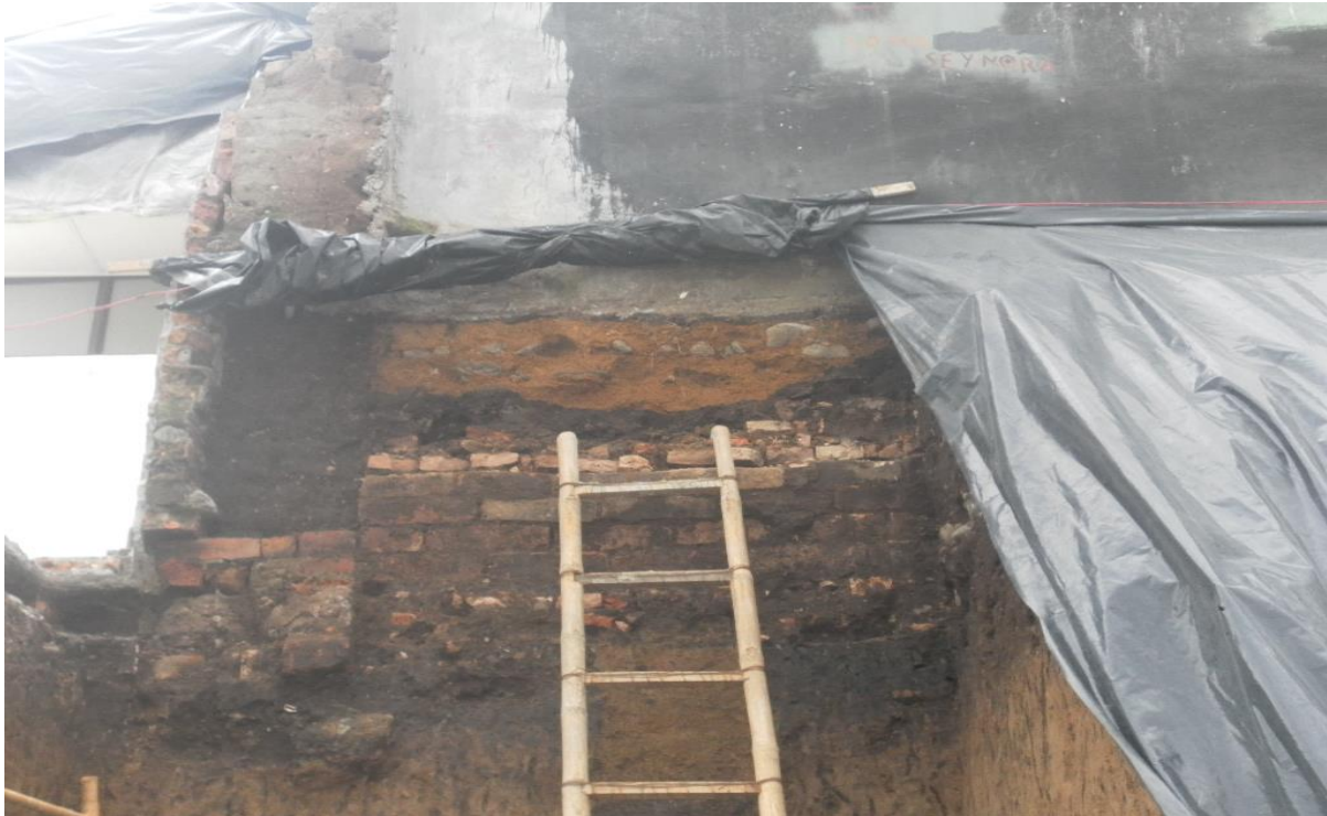
Figura 19.0 Suelo sobre el que se apoya cimentación de la edificación vecina, expuesto con la excavación.
