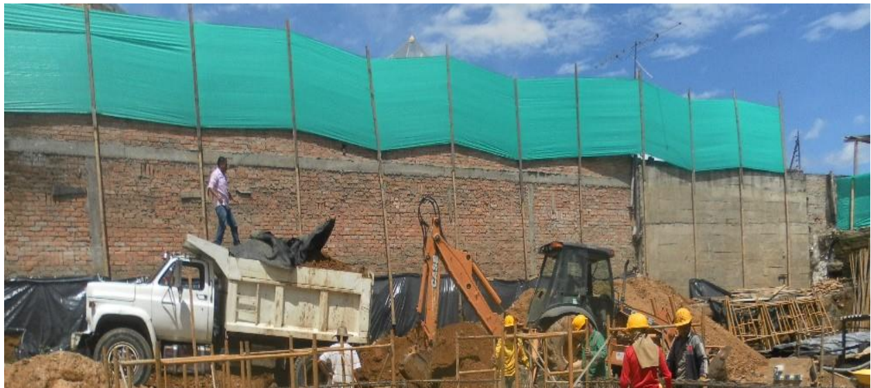
Figura 7.0. Retroexcavadora en el proceso de cargue de volqueta de 8 m 3 de capacidad.
