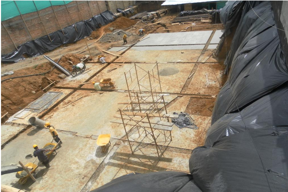
Figura 11.0. Taludes cubiertos con plástico negro.
