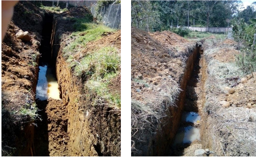
Figura 8. Nivel freático, tramo 222-220.
