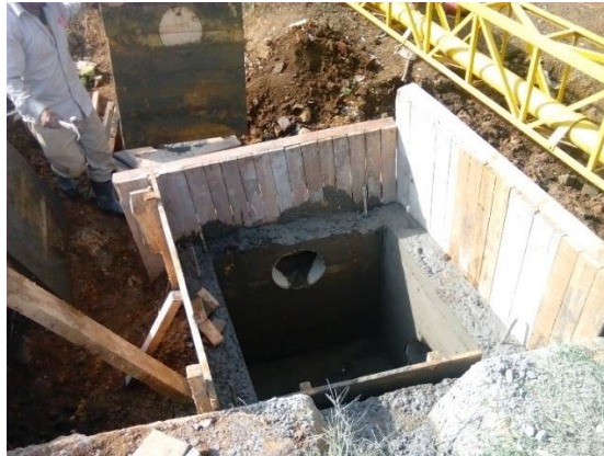
Figura 51. Caja colectora lado izquierdo de la vía en la vereda Gonzales.
