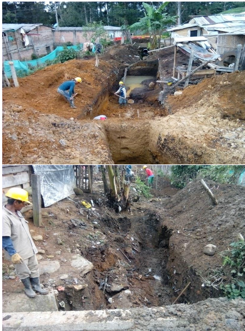
Figura 44. Inundaciones y derrumbos en excavación para canal de reducción.
