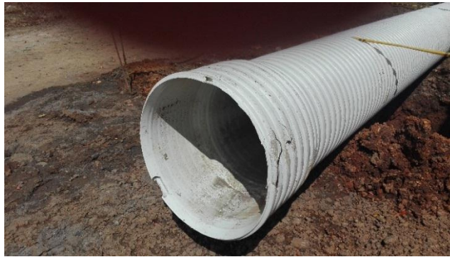
Figura 20. Tubo con campana rota.
