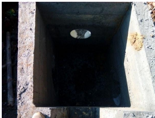
Figura 52. Caja colectora lado derecho de la vía en la vereda Gonzales.
