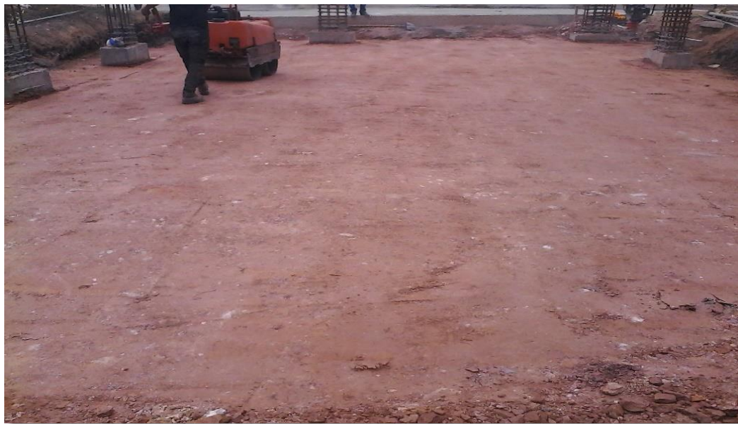
Fig. No. 24. Compactación de relleno de roca muerta con benitín Fuente propia.
