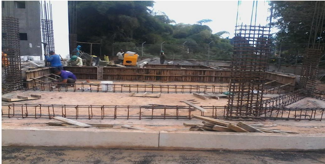
Fig. No. 23. Fundición de vigas de amarre en local comercial Fuente propia.
