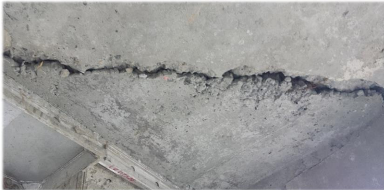
Figura 5-8. Grieta generada por junta de fundición durante el mes de diciembre. Fuente: Propia.
