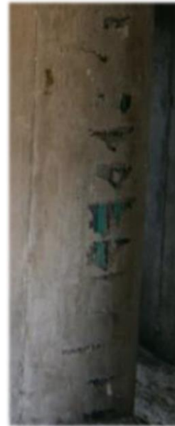
Figura 5-7. Hormiguero por congestión de instalaciones eléctricas en el primer piso. Fuente: HyC Estructural Colombia S.A.S.:
