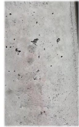
Figura 5-9. Detalle de porosidad sobre un muro fundido en diciembre. Fuente: Propia.
