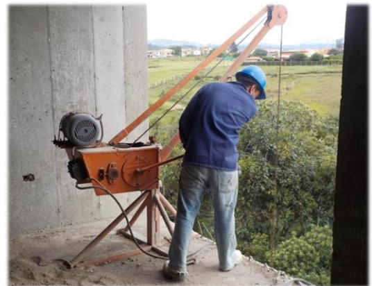
Figura 5-12. Operario sin arnés. Fuente: Propia.
