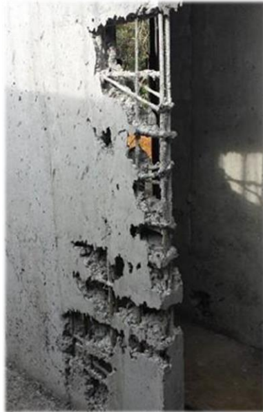
Figura 5-6. Hormiguero sobre el extremo de un muro fundido en el primer piso. Fuente: HyC Estructural Colombia S.A.S.
