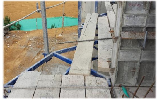
Figura 5-11. Discontinuidad en el paso. Fuente: Propia.
