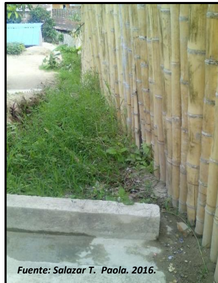
Ilustración 43. Mal Diseño de Manejo de Aguas Lluvias.
