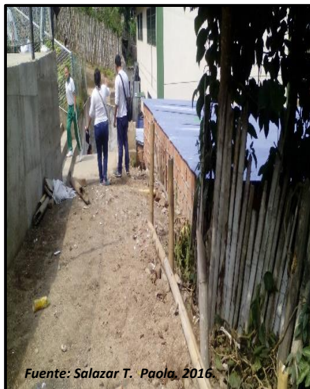
Ilustración 42. Depósito de Aguas Lluvias - Sin Canal.
