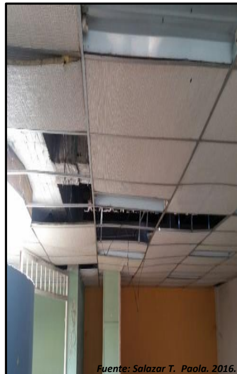
Ilustración 22. Mal Estado de Instalaciones Centro Comercial Primitivo Losada
