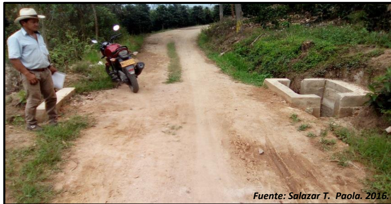
Ilustración 3. Recibo de Alcantarillas
