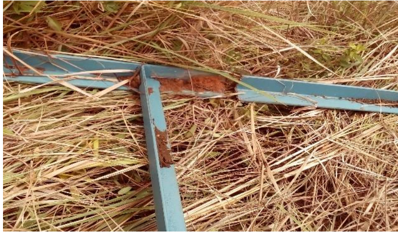
Imagen 23. Fuente propia. Ruptura de union cordon superior.
