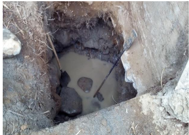
Imagen 8. Fuente propia. Excavación al lado del estribo del puente anterior Río San Pedro
