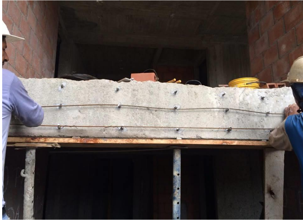
Figura No.31 Anclajes de fachaleta.
