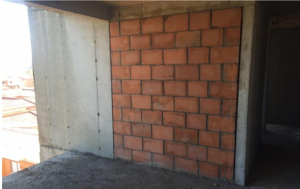
Figura No.32 Muros sin relleno
