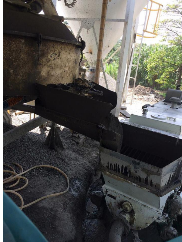
Figura No.26 Planta mezcladora y bomba estacionaria.
