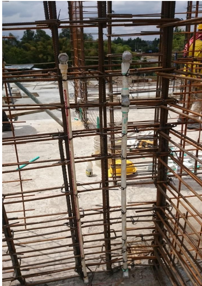
Figura N° 21: Tubería de presión en PVC.
