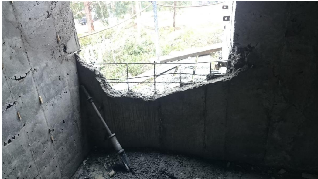
Figura N° 17: Malla elemento no estructural, antepecho mal fundido.
