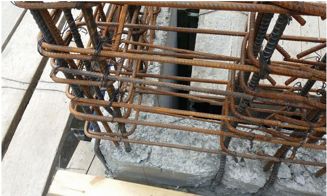
Figura N° 6: Errores después de la fundición.
