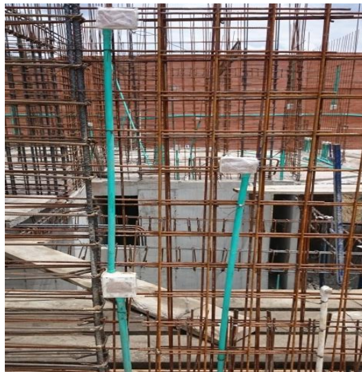
Figura N° 19: Tubería eléctrica y de telecomunicaciones en pantallas.
