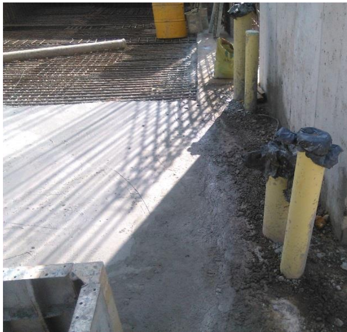
Figura N° 76: Tuberías de instalaciones sanitarias que intersectan la viga.
