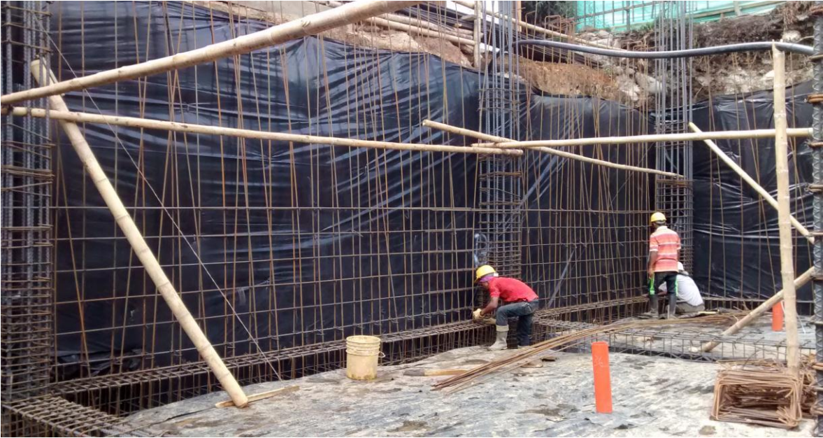
Imagen 37. Armado de pantallas con refuerzo horizontal de corrido (sin gancho y con traslapos) en el perímetro de la excavación.
