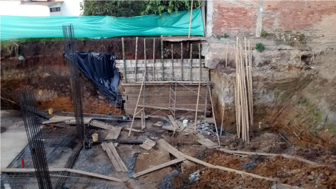
Imagen 71. Construcción de barrera de apoyo para pantallas perimetrales en zona del derrumbe.
