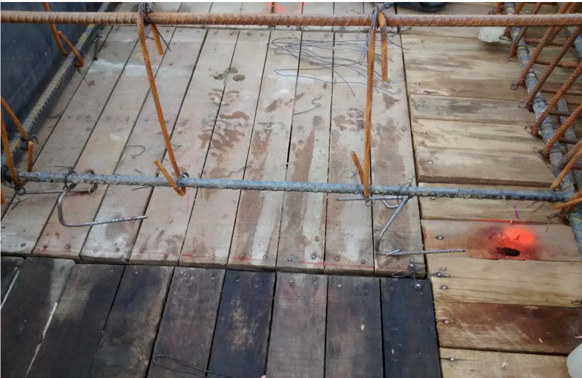
Imagen 62. Grafiles que funciona como separadores para proveer los 5 cm de recubrimiento para la vigueta. También evitan que los casetones de icopor se muevan mientras se realiza la fundición de la losa.
