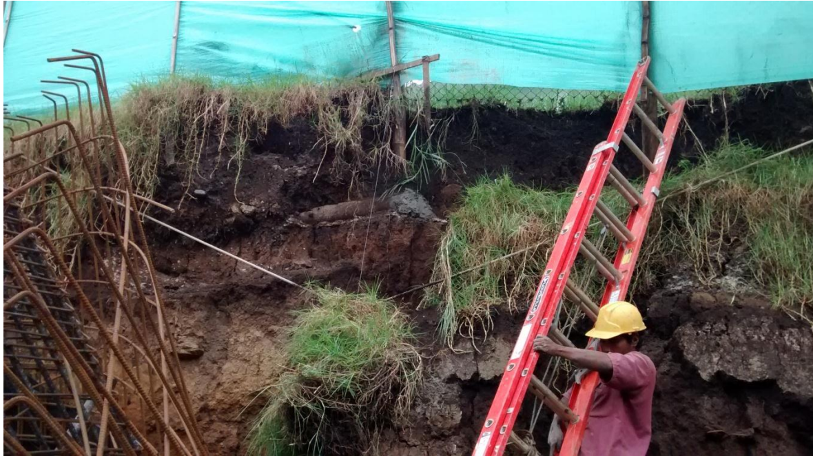
Imagen 70. Colector sellado con mortero para evitar humedecimiento del talud.
