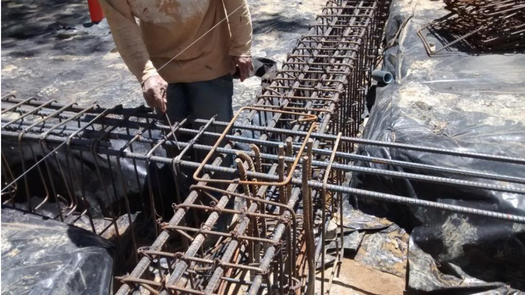
Imagen 29. Colocación primer estribo de columna a modo de guía para ubicación refuerzo longitudinal de columnas.
