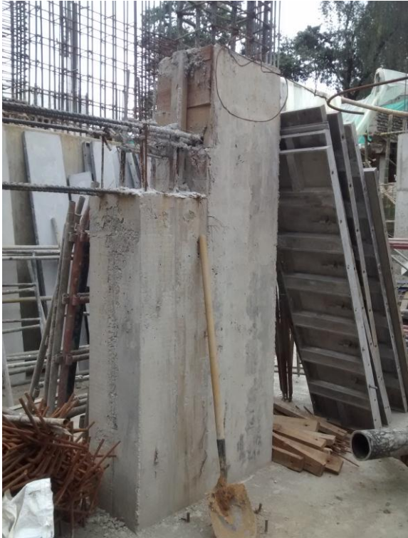
Imagen 54. Columna fundida junto a un pedestal de apoyo para las vigas de la rampa de acceso al parqueadero.
