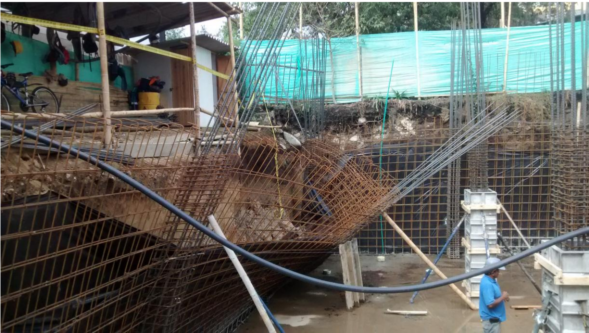
Imagen 68. Derrumbe de talud entre ejes A y B.
