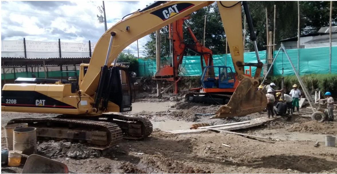
Imagen 11. Retroexcavadora Caterpillar de referencia 320B con cucharón de 0.8 m 3 usada para la excavación. Detrás se observa el vaciado del último pilote restante con concreto tremie.
