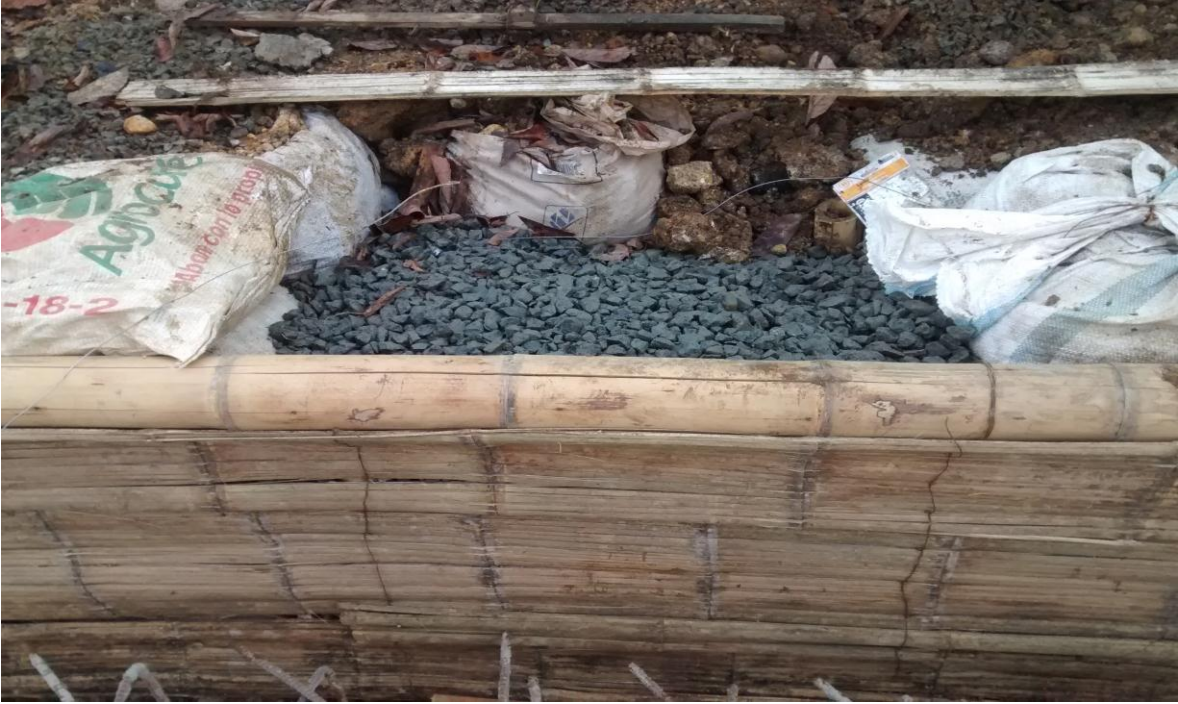
Imagen 73. Inicio de drenaje vertical con triturado, en la parte trasera de las pantallas perimetrales
