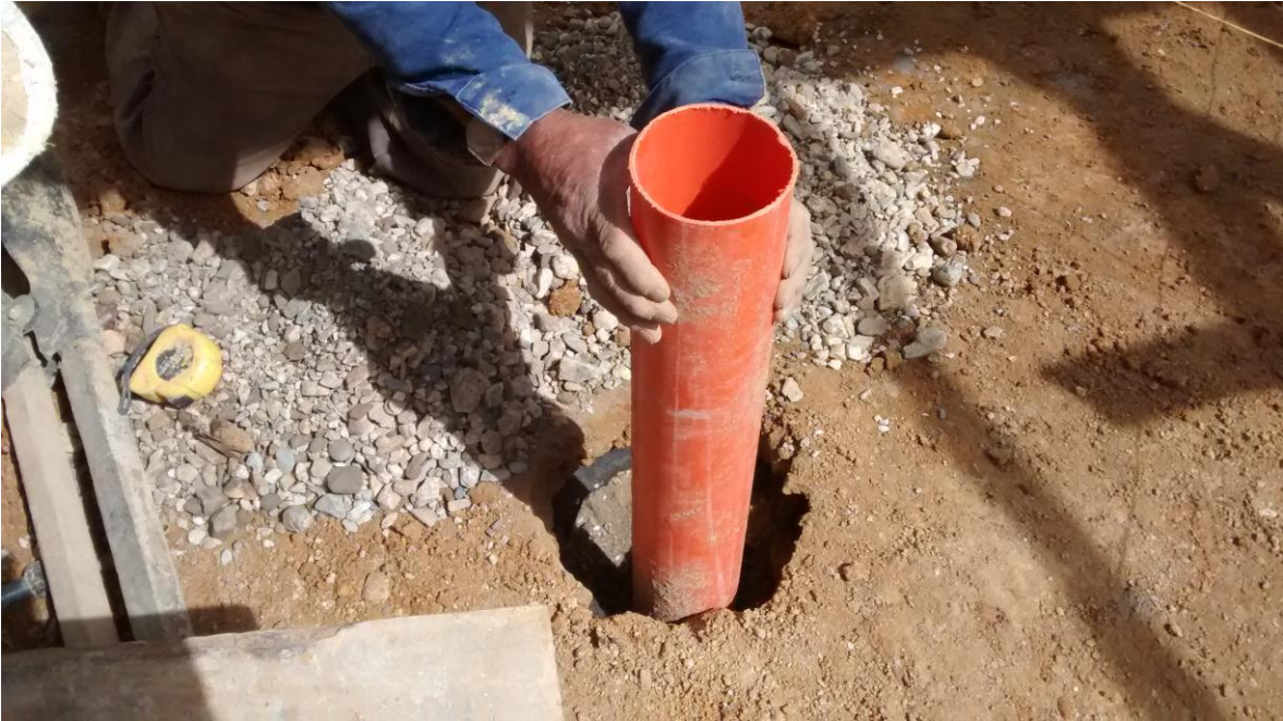
Imagen 20. Colocación de tubería PVC de 4" unida a los drenajes franceses para el desague de la losa de cimentación.
