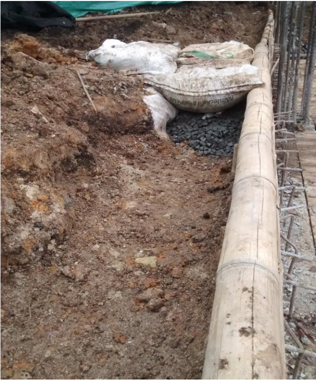
Imagen 74. Canal con dirección al drenaje vertical para encausar aguas lluvias
