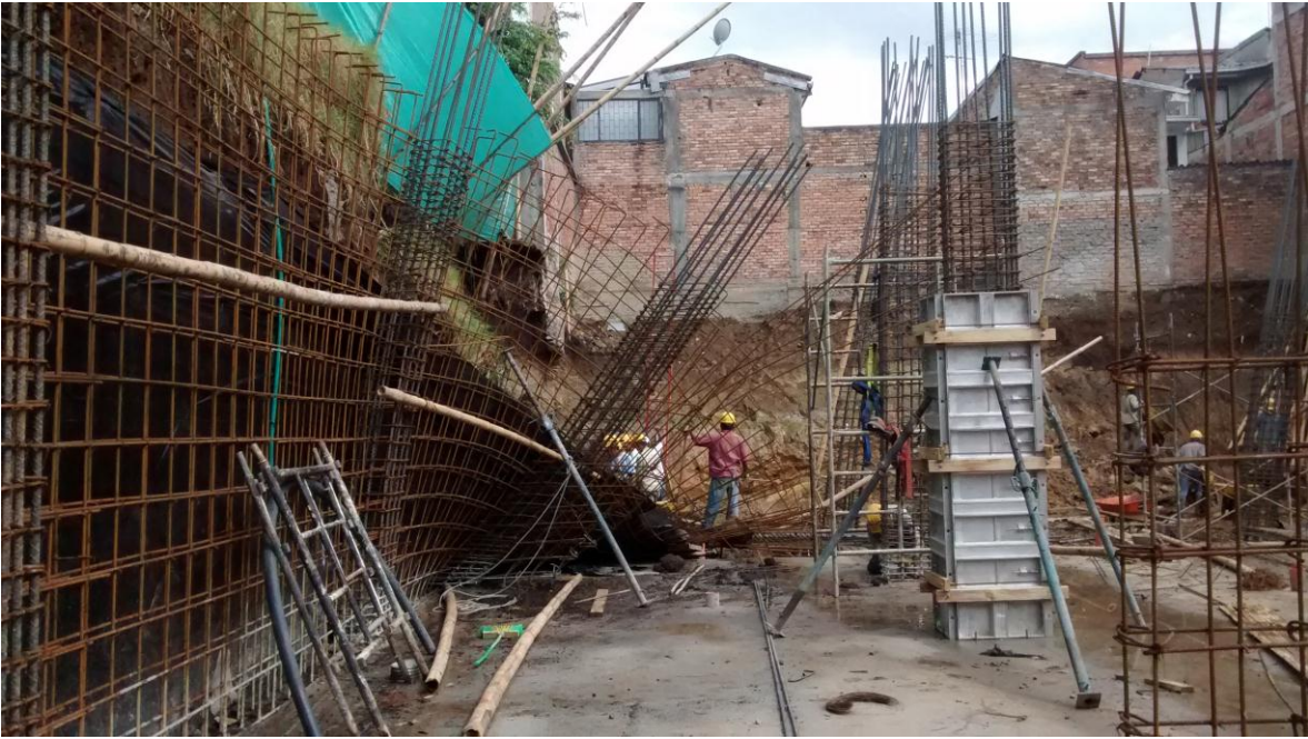
Imagen 67. Derrumbe de talud entre ejes 6 y 7.
