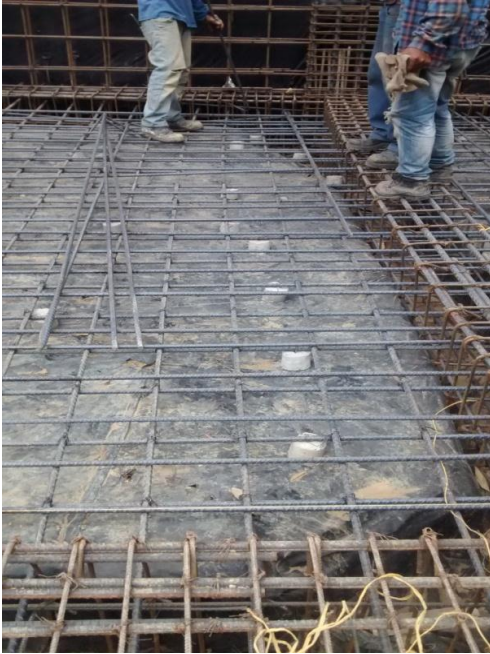
Imagen 35. Mala disposición de las "panelas" ya que se encuentran muy seguidas.
