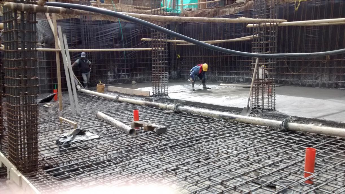
Imagen 43. Tubería desmontable, usada para el bombeo del concreto.
