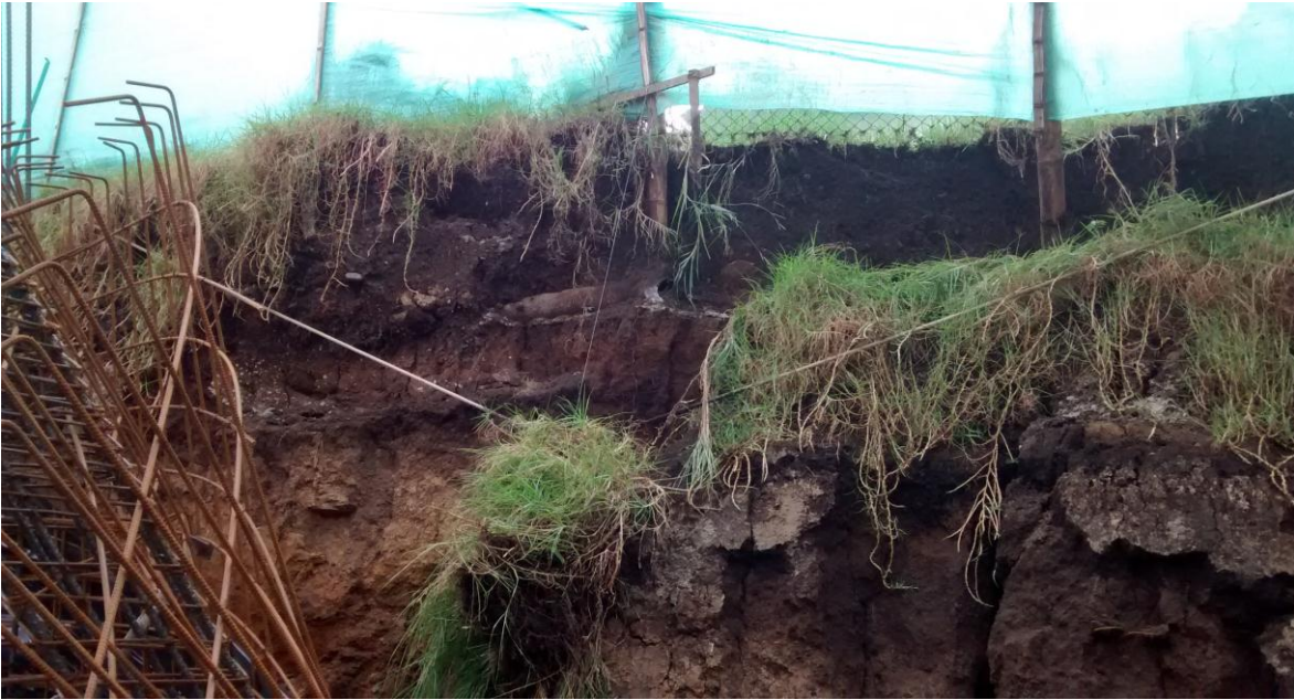
Imagen 69. Antiguo colector de alcantarillado, expuesto por el derrumbe.
