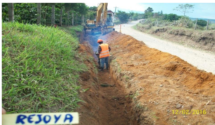
Imagen 16. Regular estado del equipo compactador tipo saltarín Vereda La Rejoja
