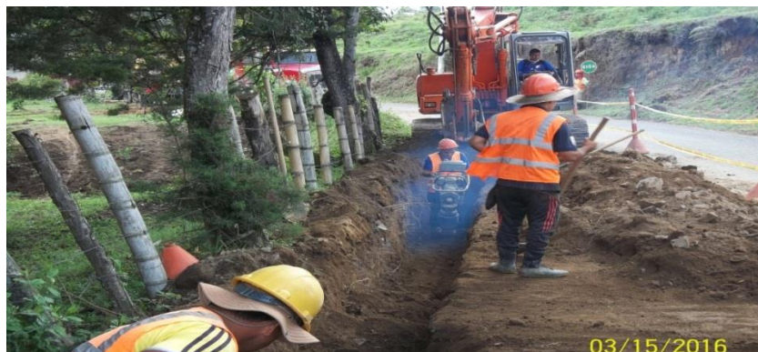
Imagen 15. Regular estado del compactador tipo saltarín, sector Calibio.
