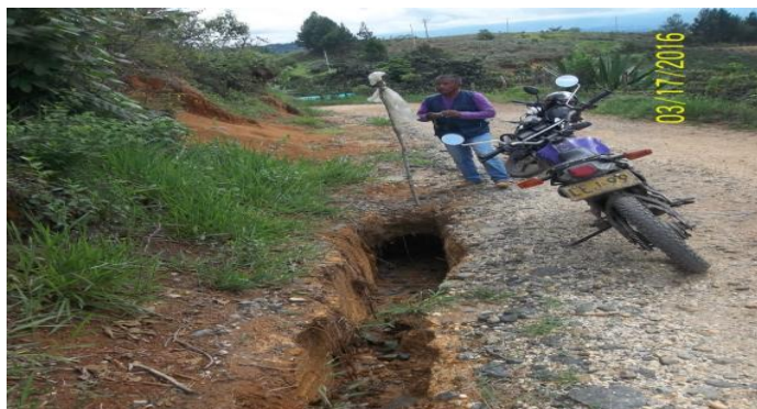
Imagen 51. Socavación línea principal San Rafael.
