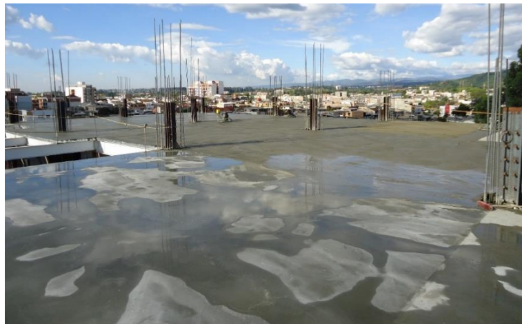
Figura 38. Curado de la losa sin protección.
