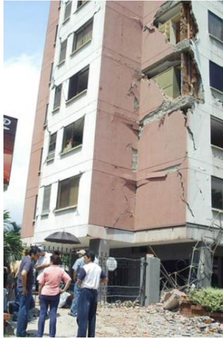
Figura 2. Muros no estructurales averiados durante un sismo Fuente: El universal, 2013
