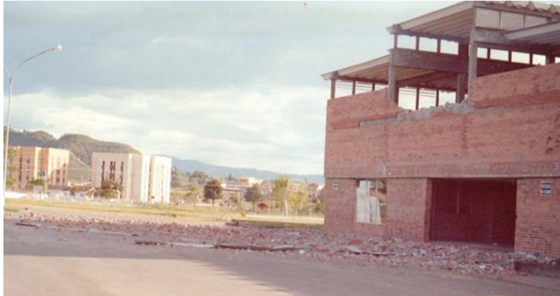
Figura 5. Caída de fachadas en un colegio en Popayán Fuente: Luis Gonzalo Mejía, 2010
