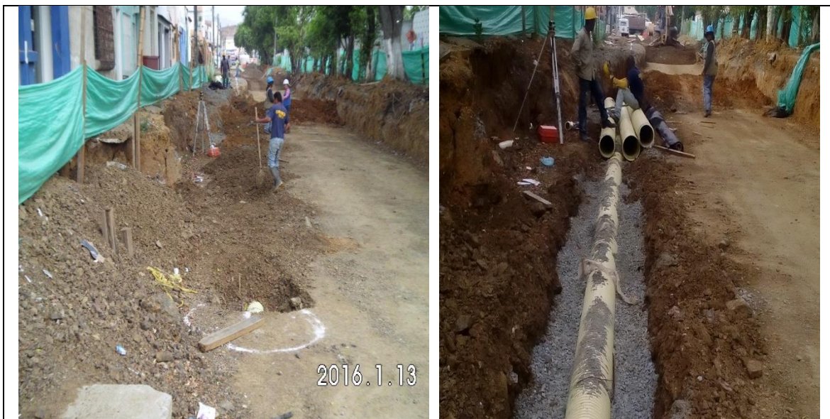
Imagen 73. Instalación tubería de 12" entre cámaras tipo B CN24-CN22 en la calle 11 entre carrera 19 y 18.
