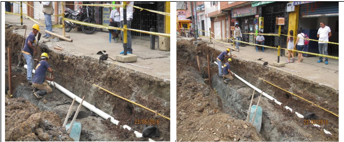
Imagen 104. Tubería de acueducto de 4" calle 9 entre carrera 17 y 16 costado oriental.
