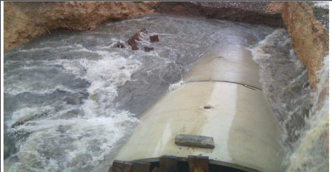
Imagen 17. Fuertes lluvias, provocan derrumbes
