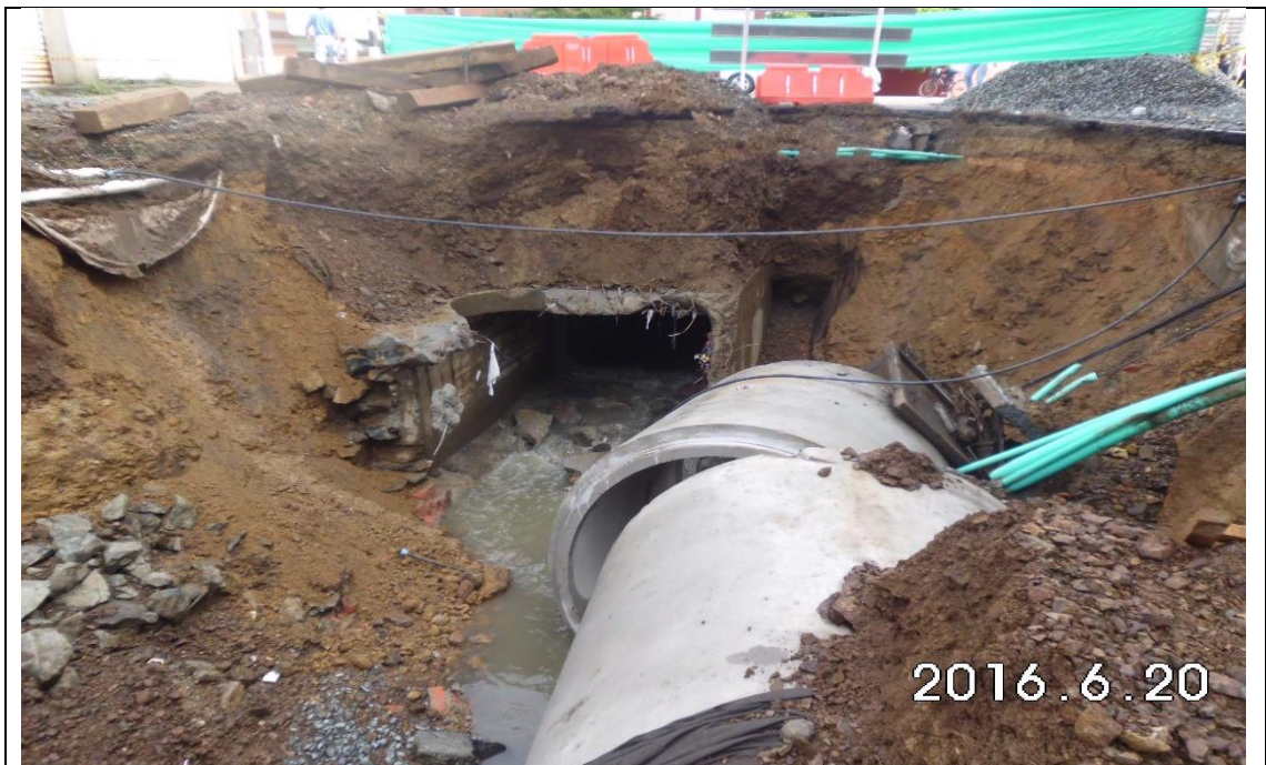
Imagen 27. Movimiento tubería por fuertes lluvias calle 9 con carrera 15
