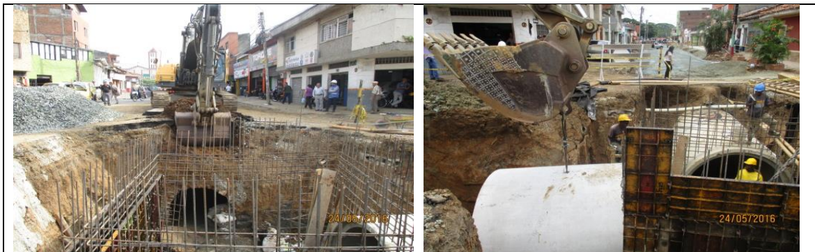
Imagen 124. Instalación de primer tubo 2.3m y construcción de cámara especial CN5 en la calle 9 con carrera 17.
