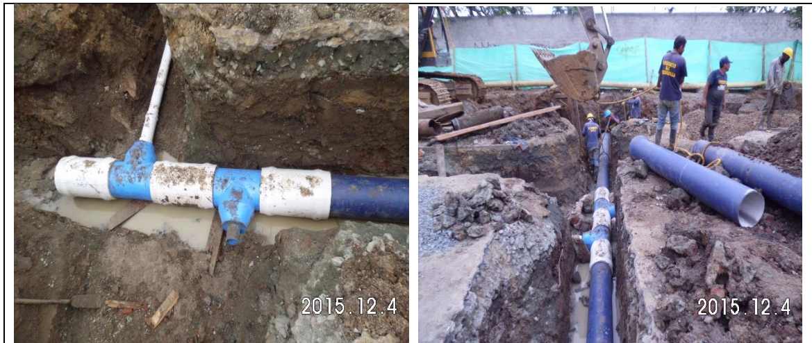
Imagen 88. Tubería de acueducto de 12" en la calle 11 con carrera 18.
