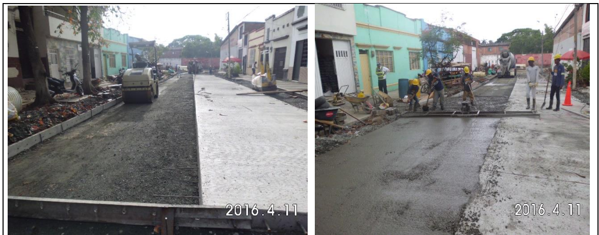
Imagen 121. Pavimento en la carrera 17 entre calle 11 y 10.
