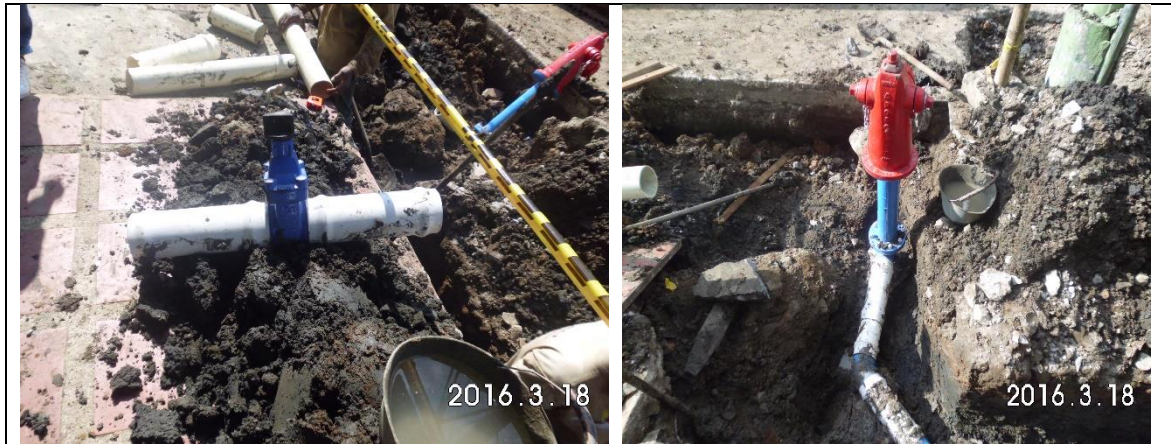
Imagen 102. Tubería de acueducto de 4" en la calle 11 con carrera 20
