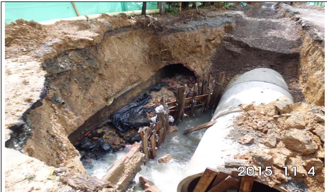
Imagen 18. Derrumbes y movimiento de la tubería por fuertes lluvias
