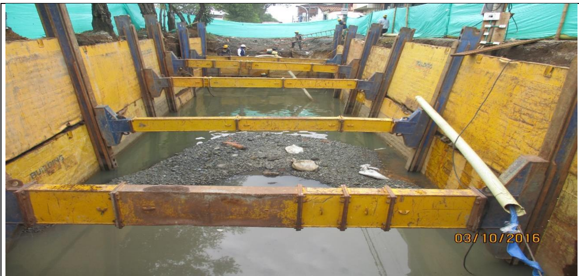
Imagen 45. Fuertes lluvias arrastraron la ataguía de la cámara especial CN13 llenando la excavación de sedimentos
