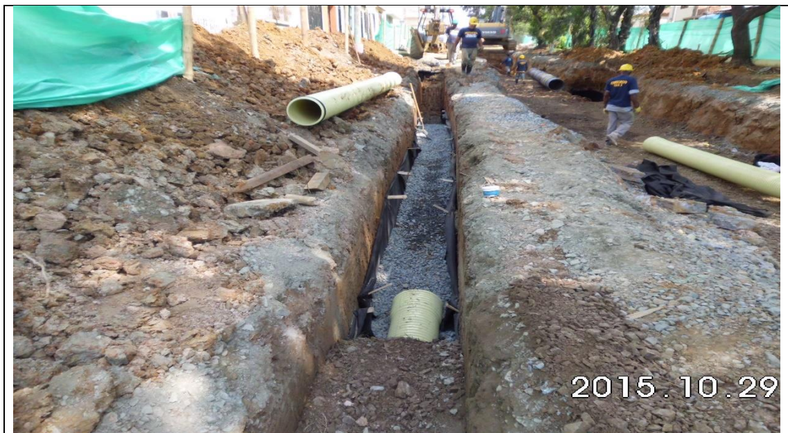
Imagen 70. Instalación tubería de 12" entre las cámaras tipo B CN28-CN26 en la calle 11 entre carrera 20 y 19.
