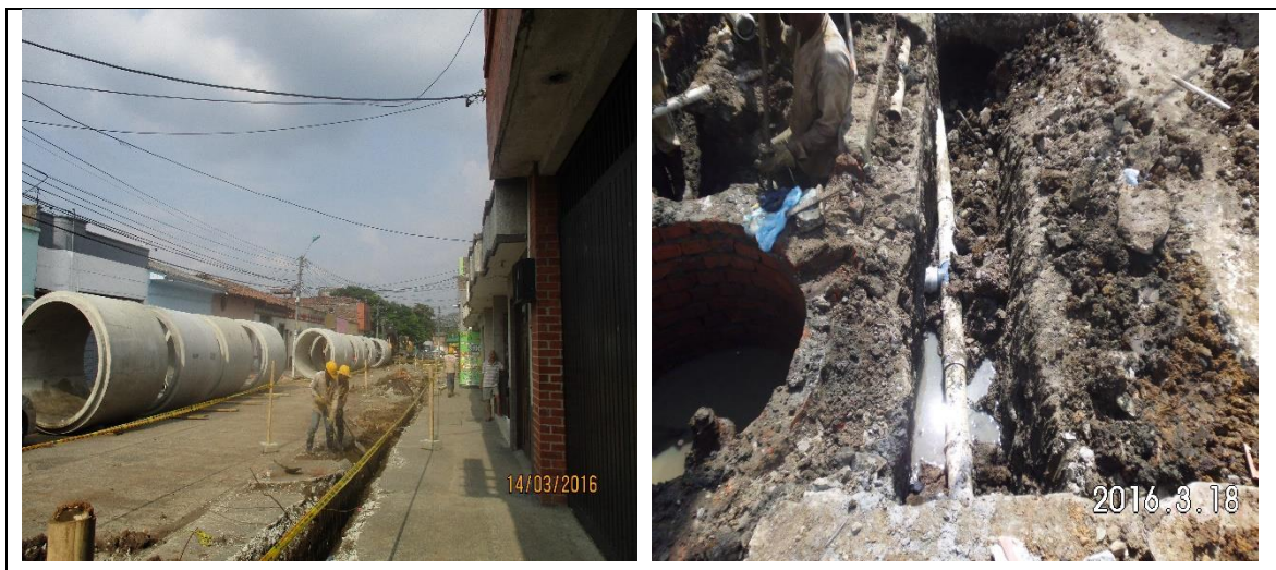
Imagen 101. Tubería de acueducto de 4" en la calle 11 con carrera 20
