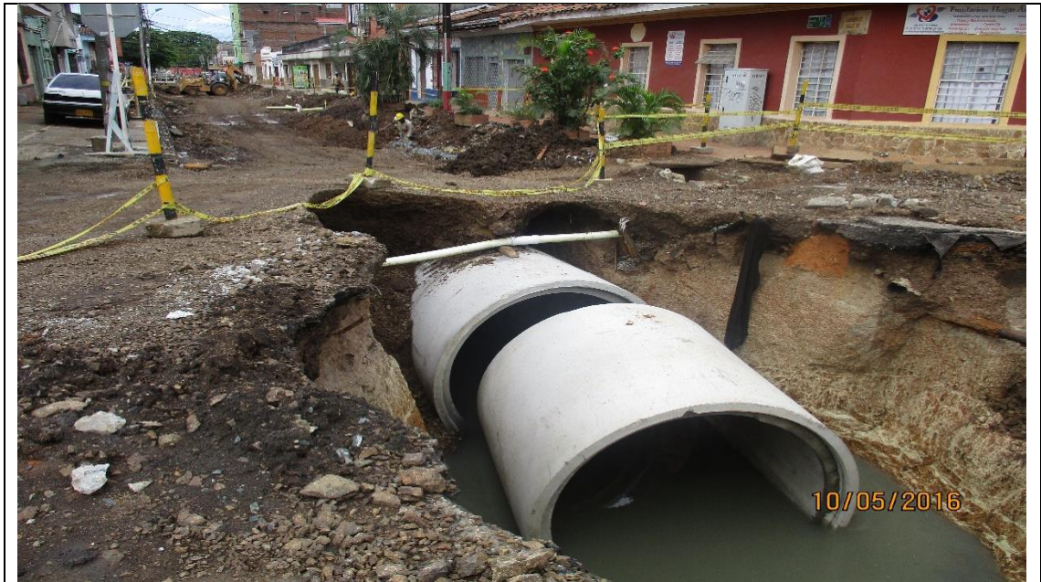
Imagen 26. Derrumbes y movimiento de la tubería por fuertes lluvias.
