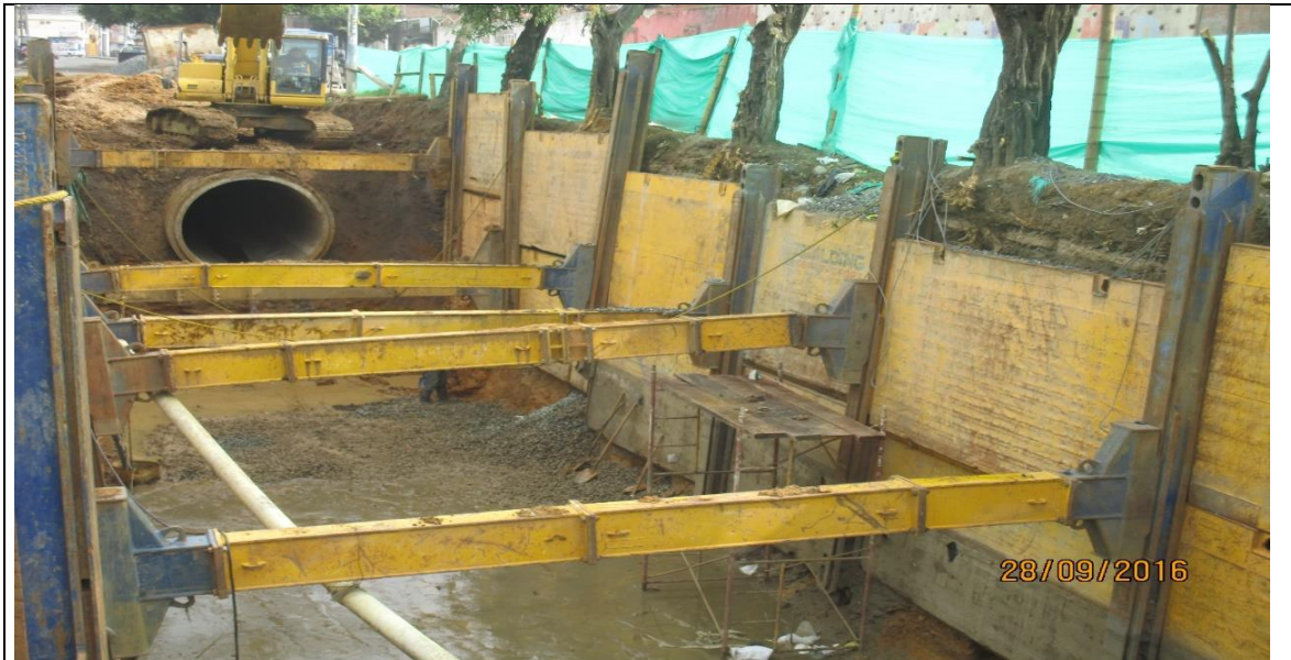
Imagen 43. Instalación del sexto módulo del entibado metálico en la calle 11 entre carrera 18 y 17 margen occidental
