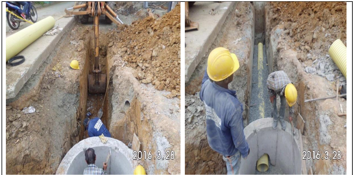
Imagen 66. Inicio de instalación tubería de 12” entre las cámaras tipo B CN31 y CN27 en la calle 11 entre carrera 20 y 19.
