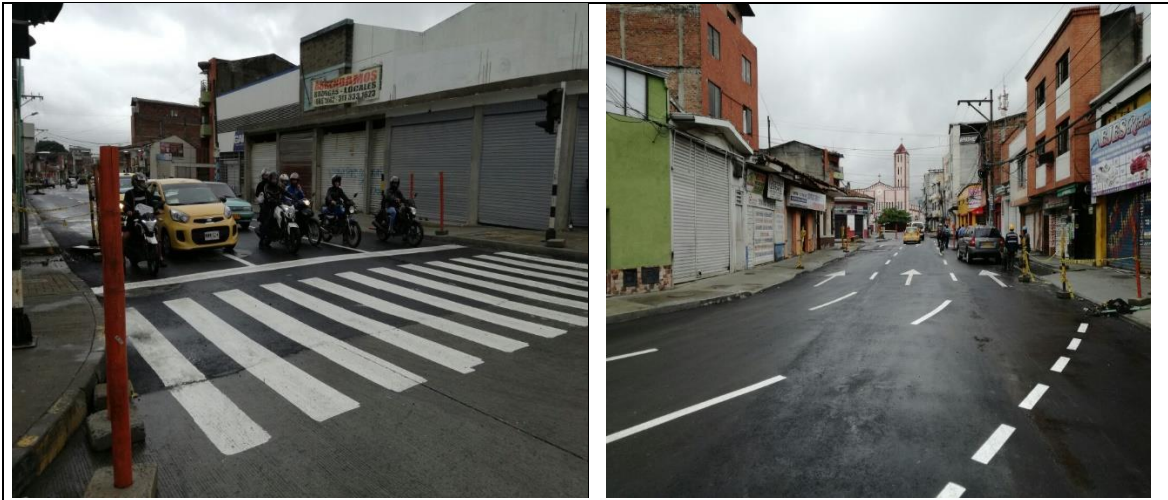
Imagen 135. Pavimento en la carrera 17 entre calle 10 y 9.
