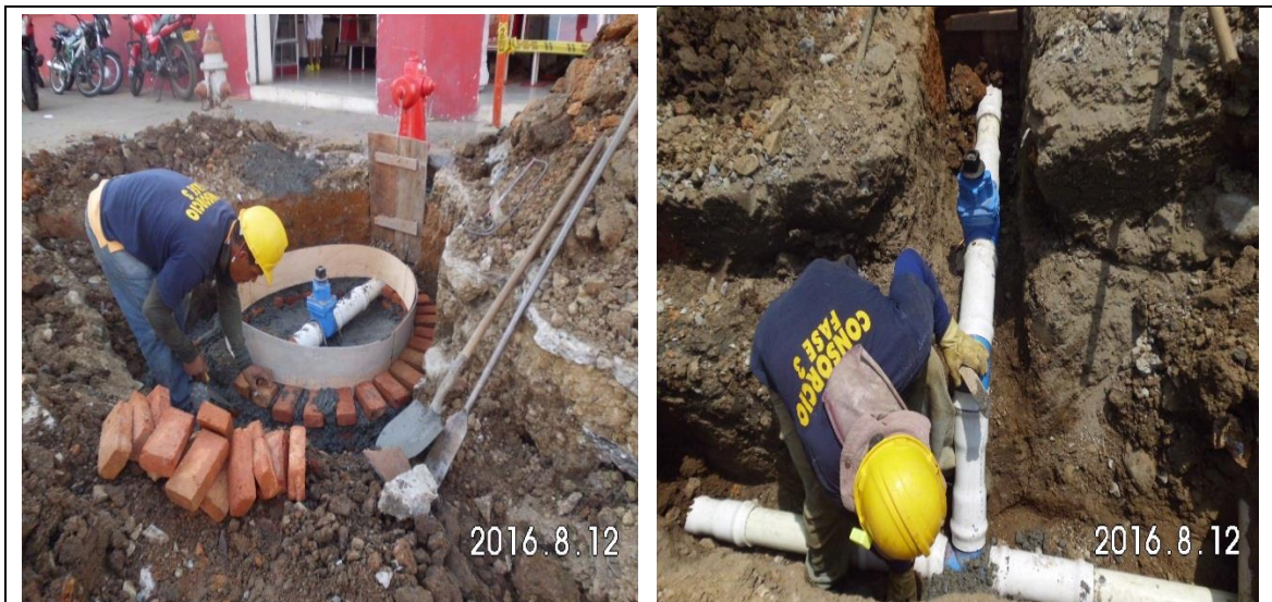
Imagen 107. Tubería de acueducto de 4" e hidrante rojo marca Mega e válvula de compuerta extremo liso calle 9 con carrera 16 costado oriental.
