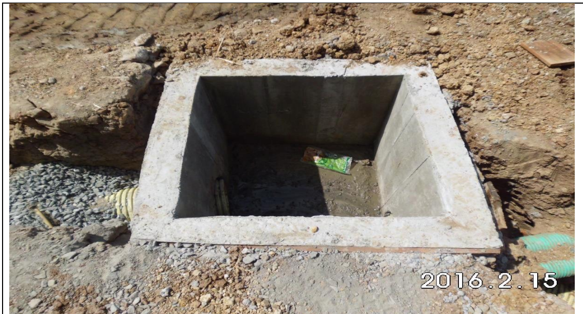
Imagen 63. Cajas domiciliarias en la calle 11 entre carrera 21 y 20.
