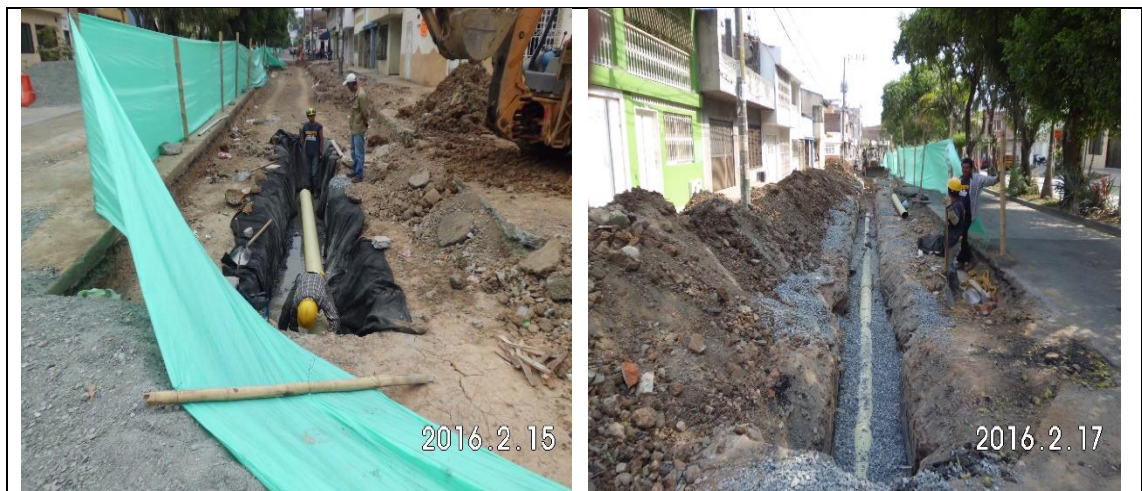
Imagen 61. Instalación tubería de 10" entre las cámaras tipo B CN26A-CN28A en la calle 11 entre carrera 21 y 20.
