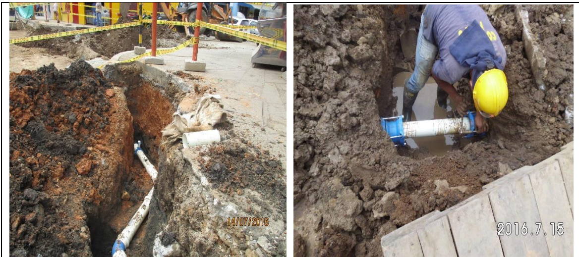
Imagen 105. Instalación de tubería de 4" de acueducto y uniones universal 4" en la calle 9 con carrera 16 margen occidental.
