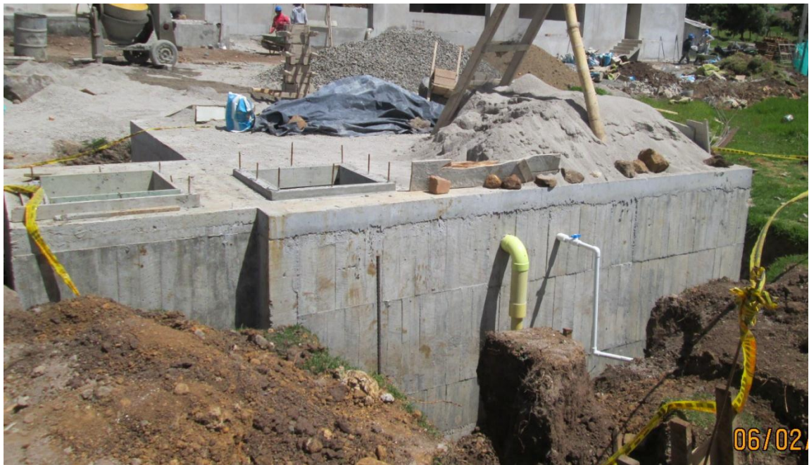
16. Tanque de almacenamiento
