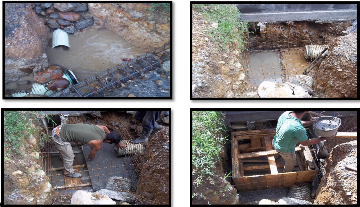
Figura 28. Caja de Inspección para el descole
