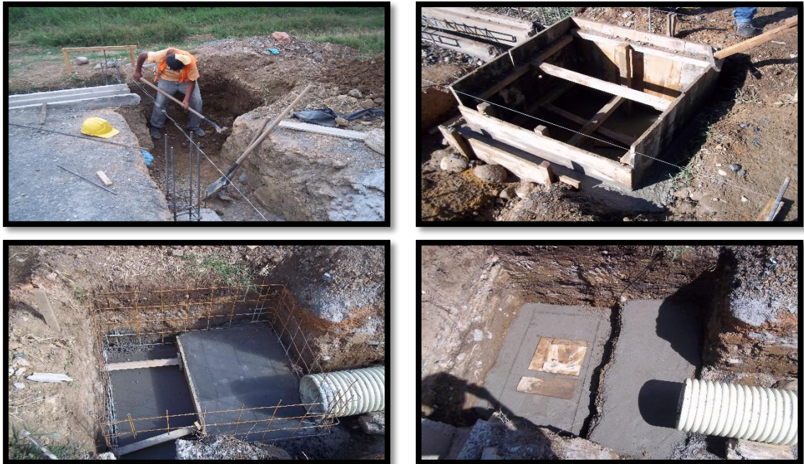
Figura 25. Caja de Inspección 1m x 1m lateral derecha cancha
