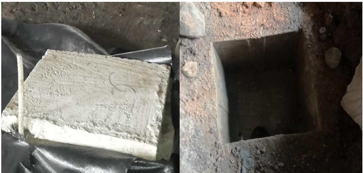
Figura30. Tapa de concreto Figura31. Caja de Inspección.
