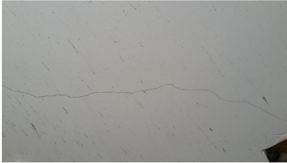
Fotografía 44. Fisuras en los acabados. Fuente: Tomada por el pasante
