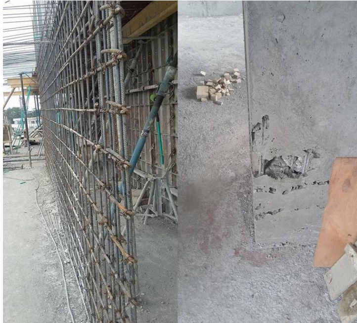
Fotografía 60. Muro amarrado en su totalidad, hormigueros encontrados en la estructura. Fuente: Tomada por el pasante
