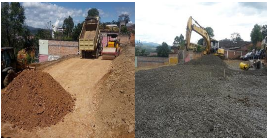
Fotografía 4. Se procede a la compactación de material. Fuente: Tomada por el ingeniero residente
