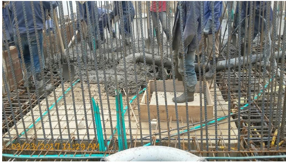
Fotografía 15. Vaciado y vibrado del concreto en la losa. Fuente: Tomada por el pasante
