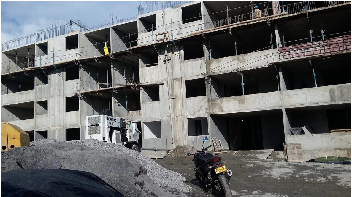
Fotografía 41. Vista frontal de la construcción total del 4to piso. Fuente: Tomada por el pasante
