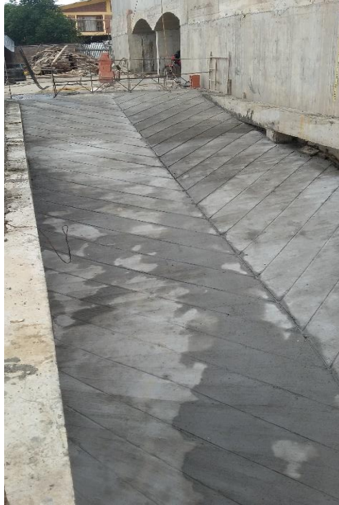
Fotografía 54. Vista de la rampa de acceso al parqueadero terminada. Fuente: Tomada por el pasante
