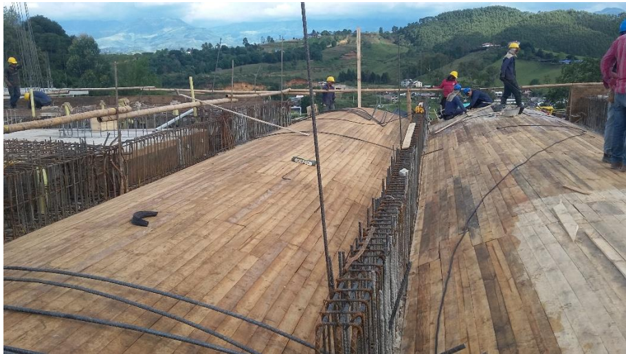
Fotografía 10. Vista en superficie de la formaleta de la losa. Fuente: Tomada por el pasante
