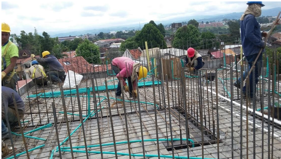
Fotografía 56. Instalaciones eléctricas del apto del 5to piso. Fuente: Tomada por el pasante
