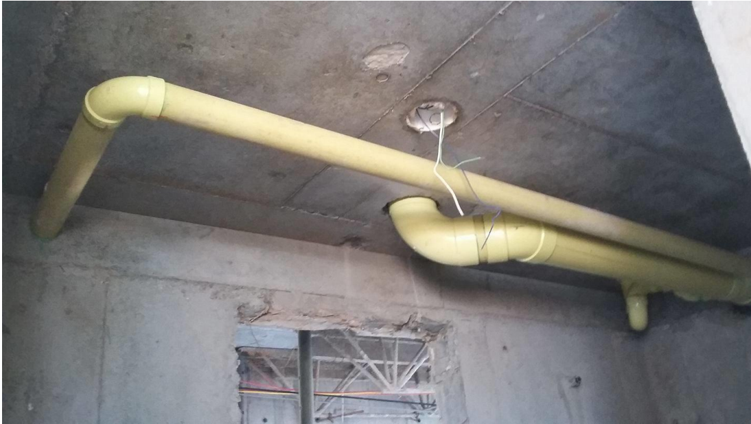
Fotografía 61, Instalaciones hidráulicas en los baños del apto. Fuente: Tomada por el pasante
