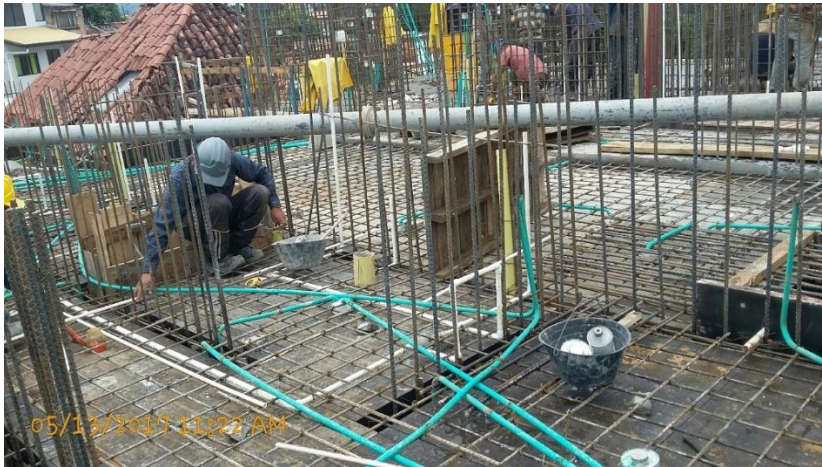
Fotografía 27. Instalaciones hidráulicas y eléctricas del apto 2. Fuente: Tomada por el pasante
