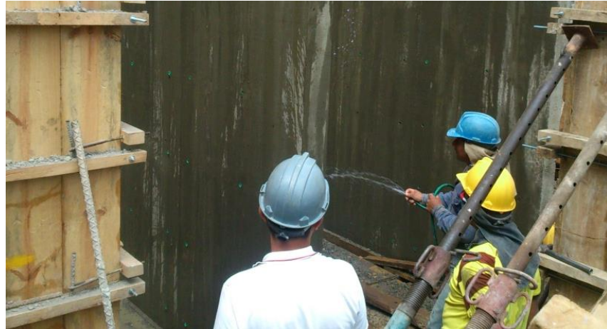
Figura 40. Humedecimiento de pantallas después de desencofrar
