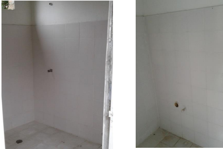
Figura 13. Edificación inconclusa de uno de los servicios sanitarios
