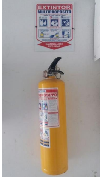
Figura 18. Extintor correctamente ubicado
