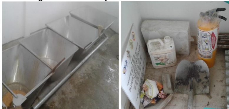
Figura 4. Áreas de riesgo no definidas y extintores mal ubicados
