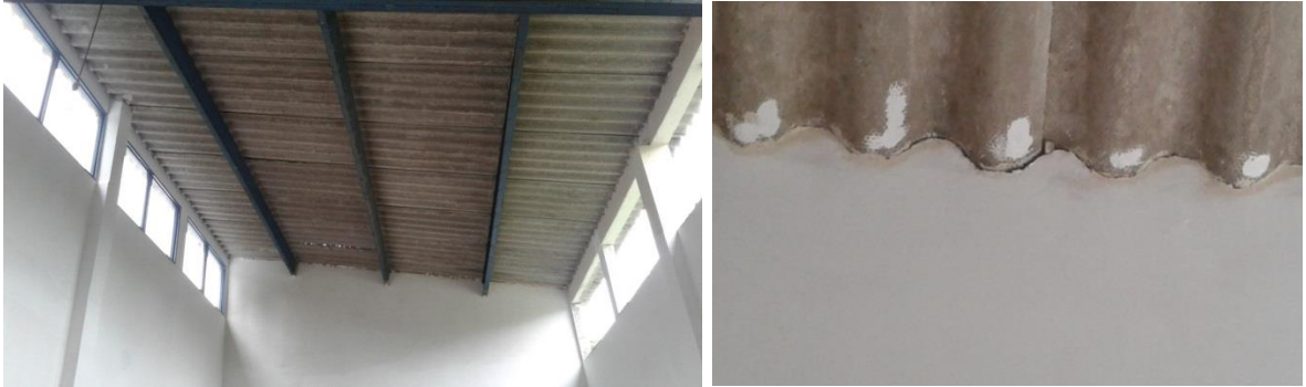
Figura 8. Condiciones del techo del trapiche
