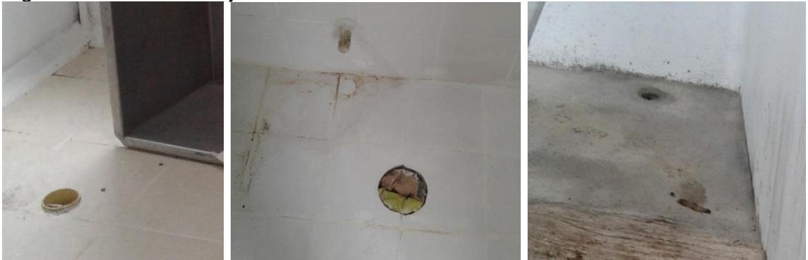
Figura 7. Sifones sin rejilla
