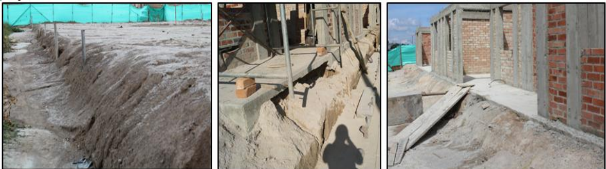
Ilustración 6.40 Material socavado por la lluvia
