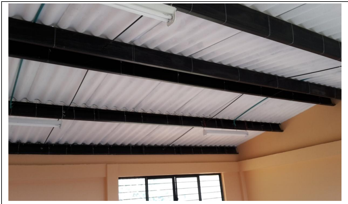
Fotografía 4. Perfil metálico en C y tensores de la cubierta, vereda Ortega Llanos
