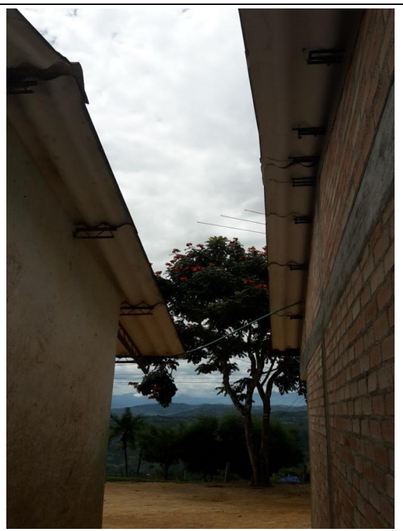
Fotografía 13. Muro lateral del aula donde se presentaron las grietas
