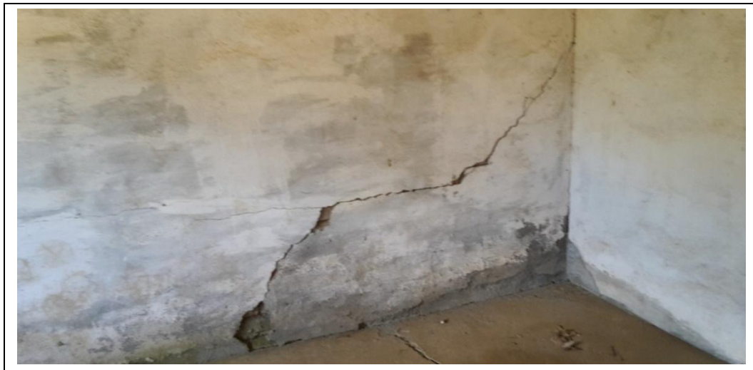
Fotografía 35. Muro interno del salón con fisuras en dos sentidos
