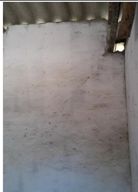
Fotografía 34. Muro portante sin viga de amarre
