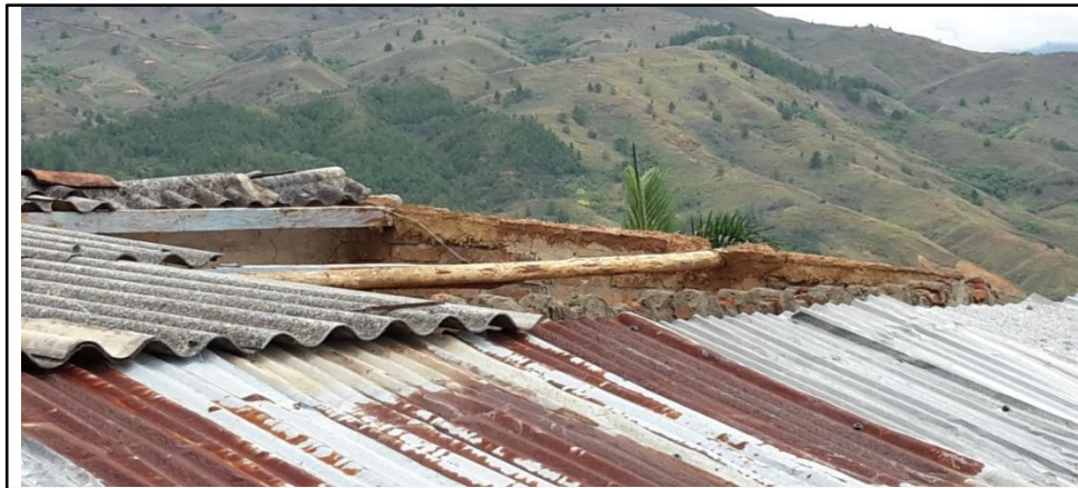
Fotografía 30. Vista superior de cubierta afectada, casa de Jhon Jairo Montenegro
