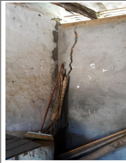
Fotografía 33. Muro frontal agrietado sin viga de amarre sostiene teleros sobrepuestas
