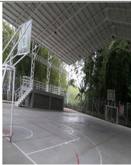
Fotografía 45. Vista interna CIC terminado
