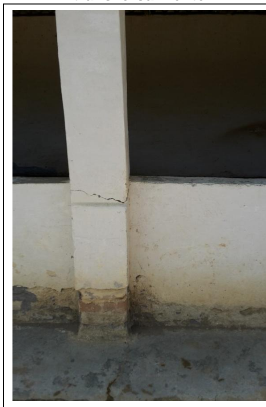
Fotografía 36. Columna sin hierro, fracturada transversalmente
