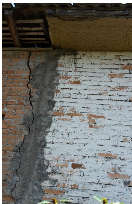
Fotografía 37. Muro trasero fracturado verticalmente
