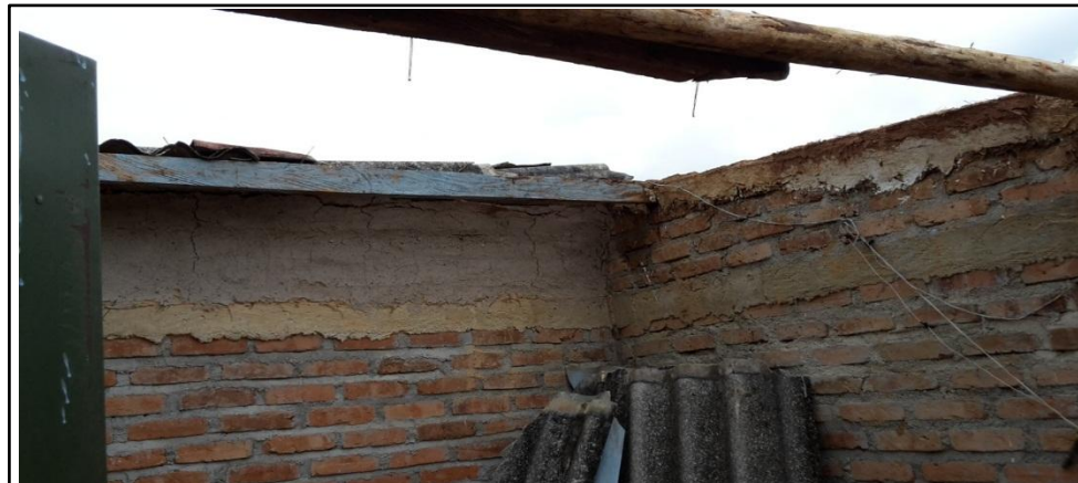
Fotografía 31. Vista interna habitación afectada, casa de Jhon Jairo Montenegro
