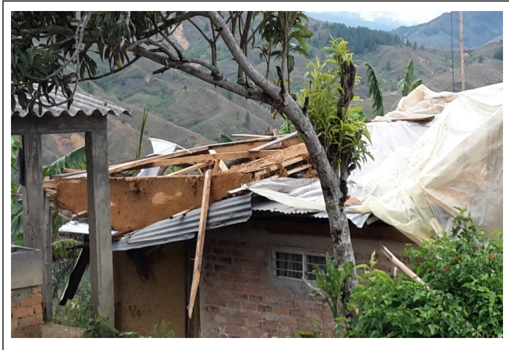
Fotografía 28. Daños generados en la parte trasera de la vivienda del señor Fidel
