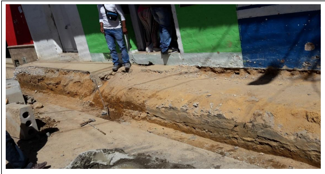
Fotografía 53. Nivel de andén demasiado alto genera problema de estética.
