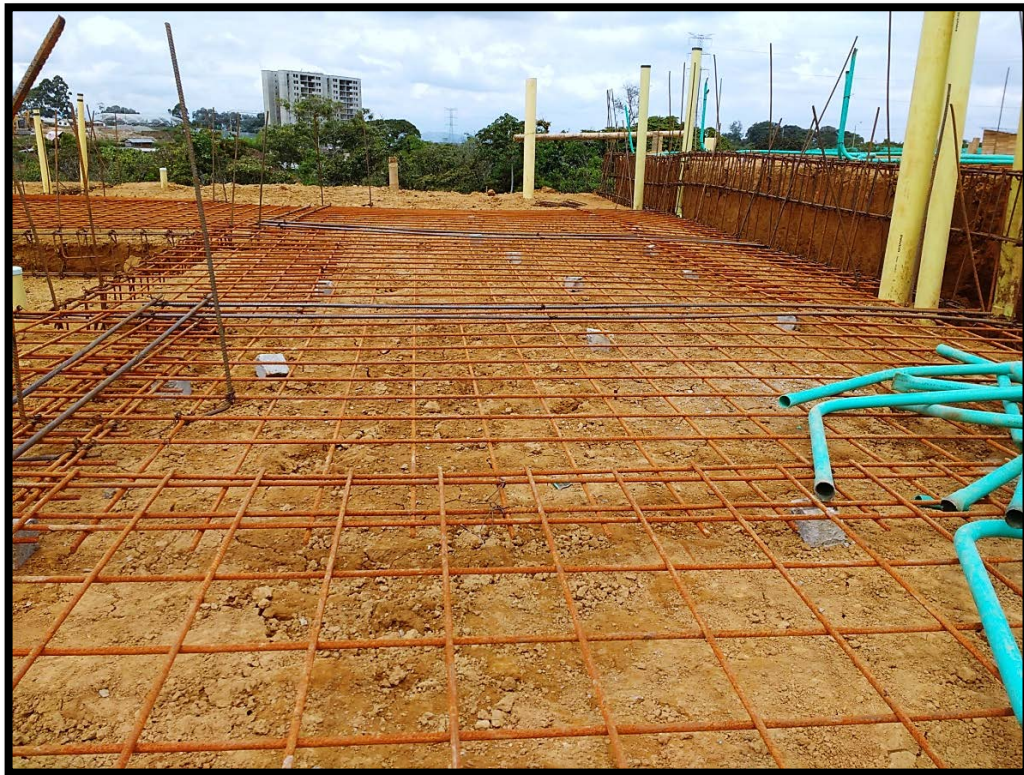
Ilustración 31. Mala ubicación de acero de refuerzo en losa de cimentación
