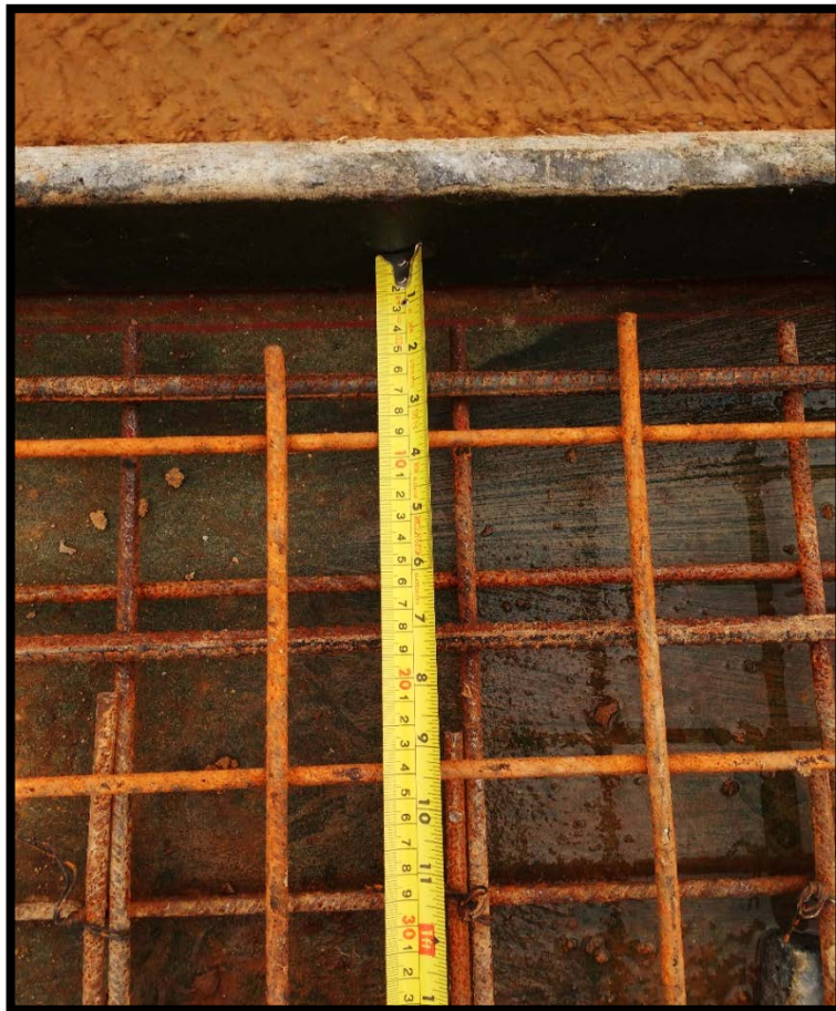
Ilustración 37. Separación incorrecta en acero de refuerzo en corte V4 eje 0 entre A-C
