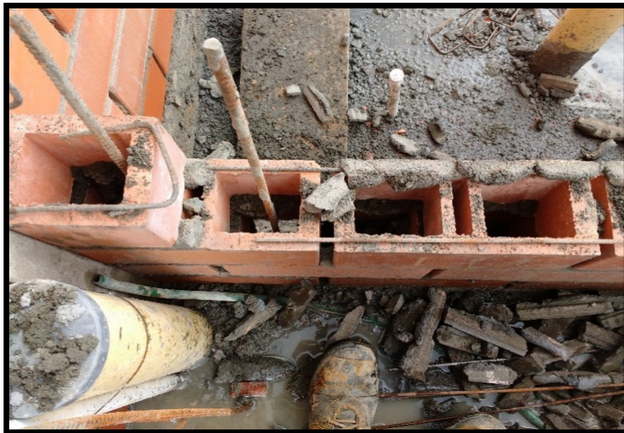
Ilustración 29. Mal procedimiento en la instalación de grafiles
