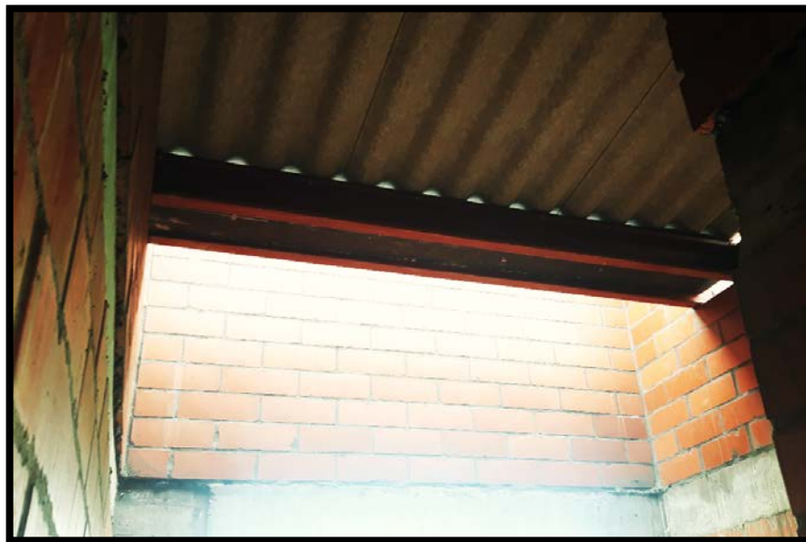
Ilustración 47. Canaleta para aguas lluvia
