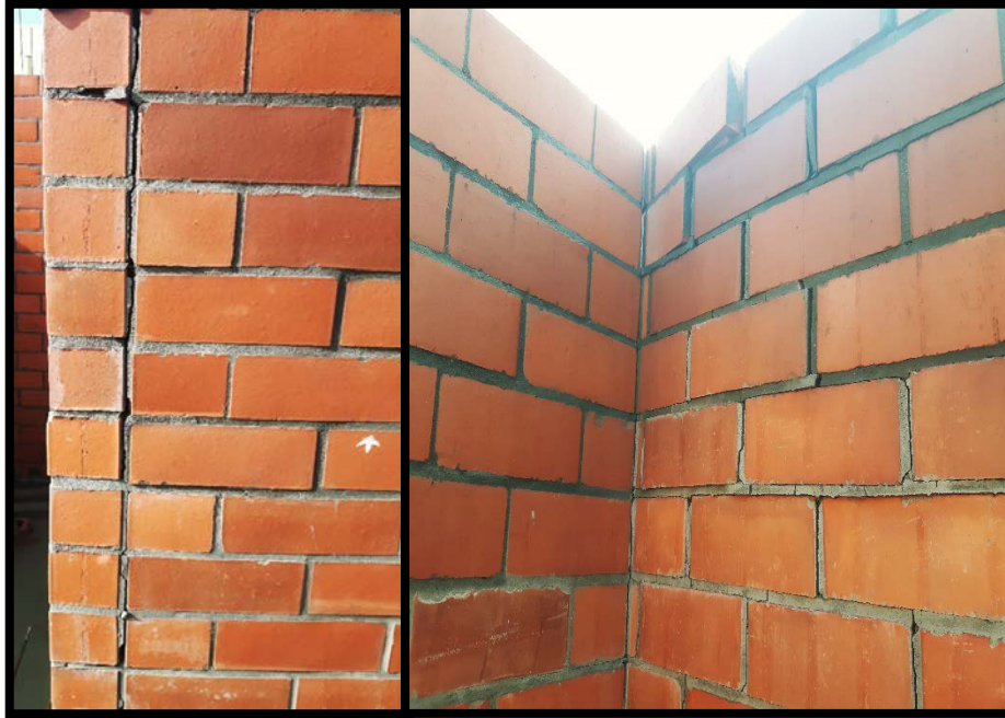
Ilustración 28. Muro deficiente en pega
