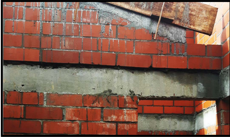
Ilustración 43. Retroceso en vigas de amarre
