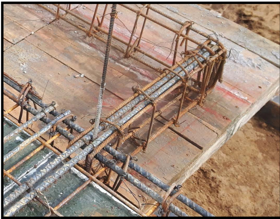
Ilustración 36. Viga en voladizo losa entrepiso con errores
