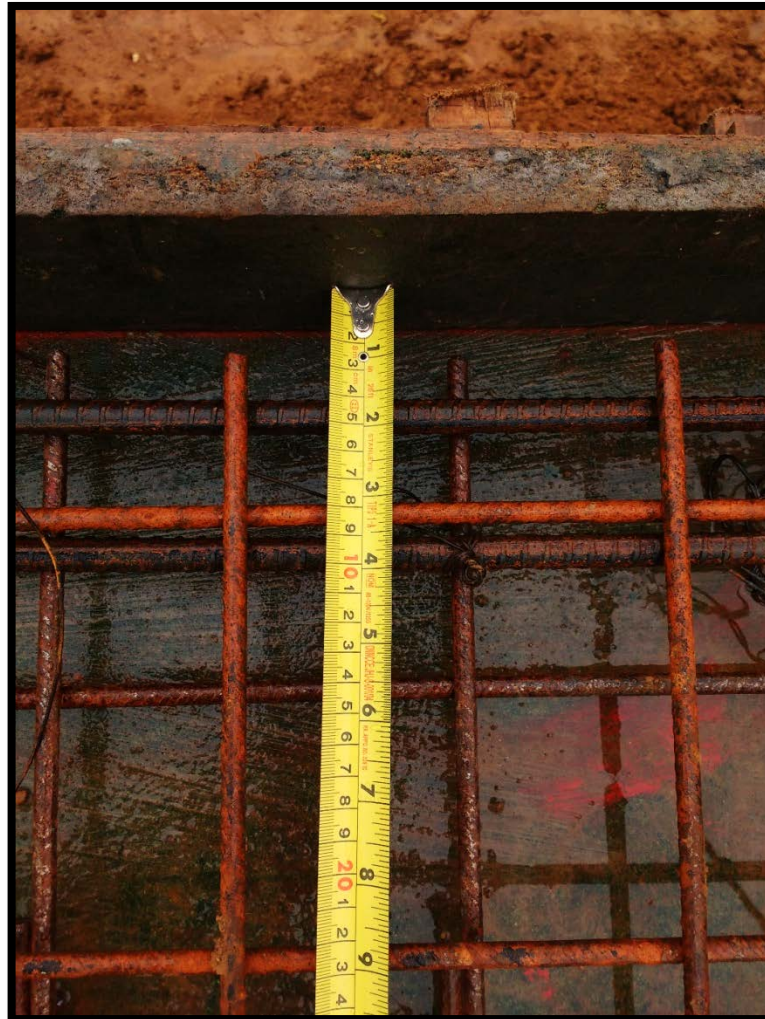
Ilustración 38. Corrección en la separación del refuerzo V4
