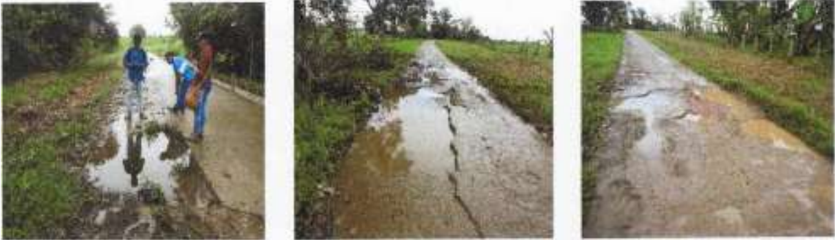
Figura. 4 estado actual vía puerto Leguizamo la tagua
